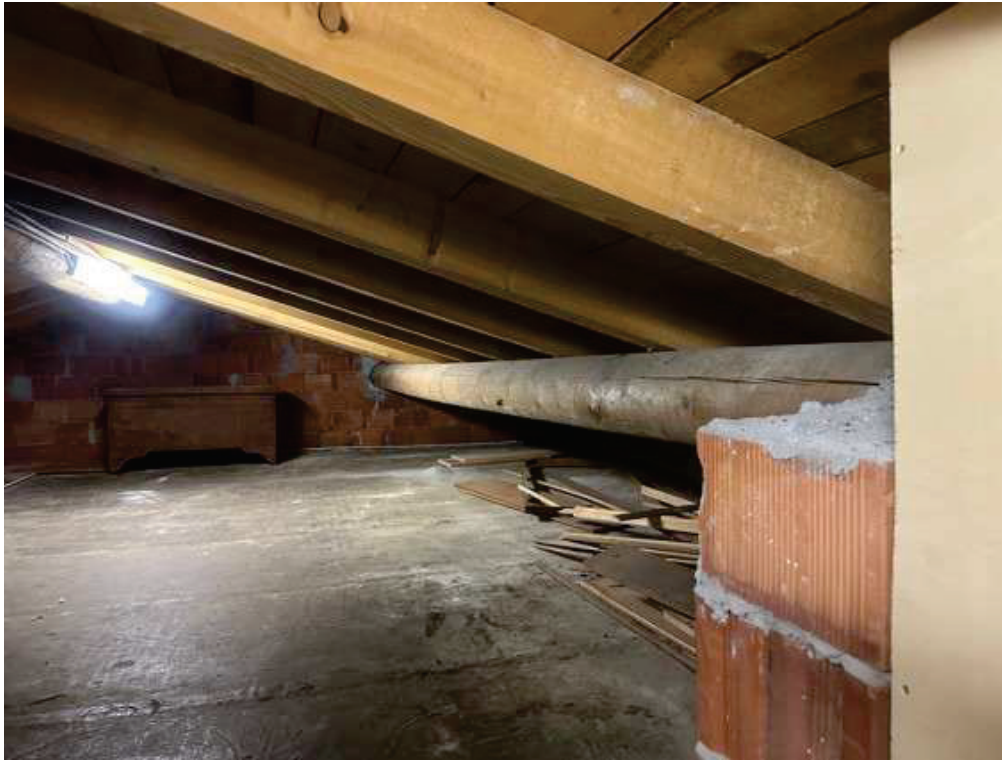
Fotografia E.47 - Solaio sottotetto sub.16 - Prima della modifica della dividente
