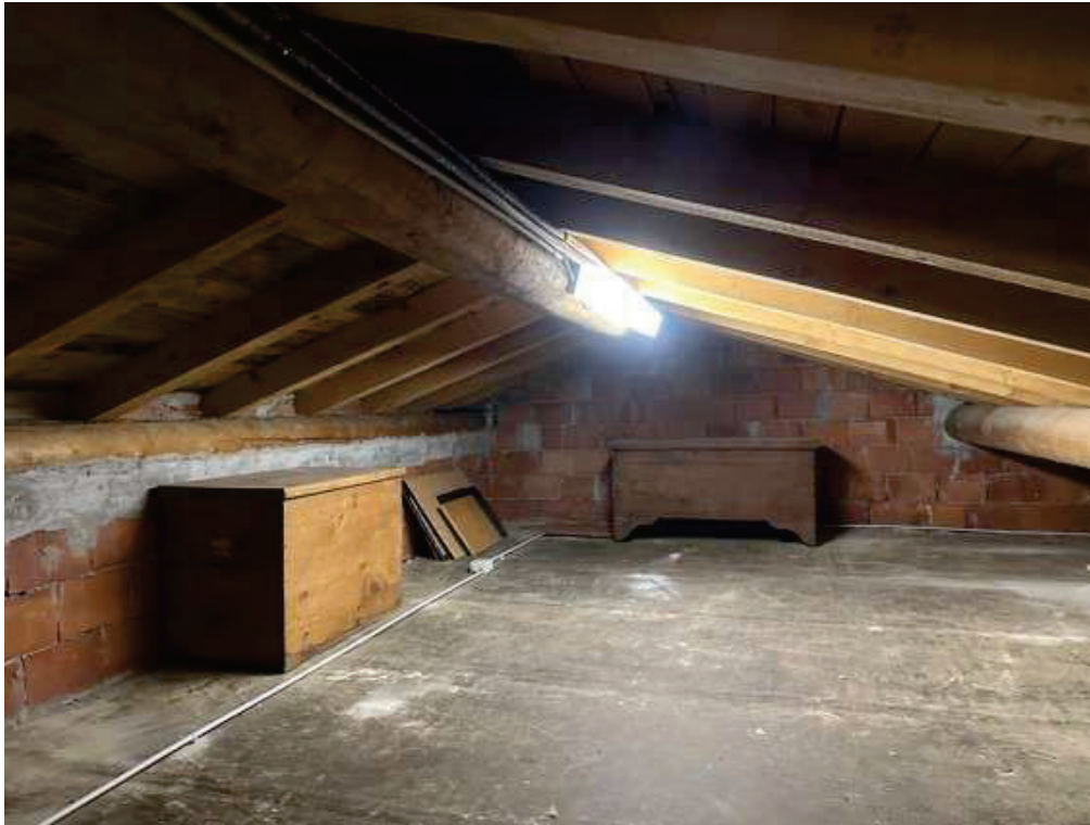
Fotografia E.49 - Solaio sottotetto sub.16 - Prima della modifica della dividente
