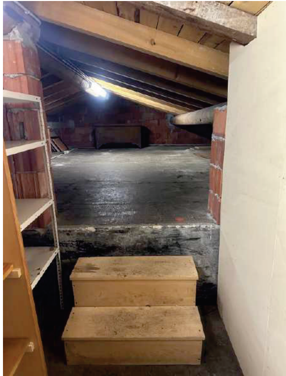
Fotografia E.45 - Solaio sottotetto sub.16 - Prima della modifica della dividente
