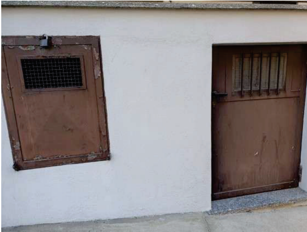
Fotografia E.53 - Centrale termica: bcnc sub.3_a
