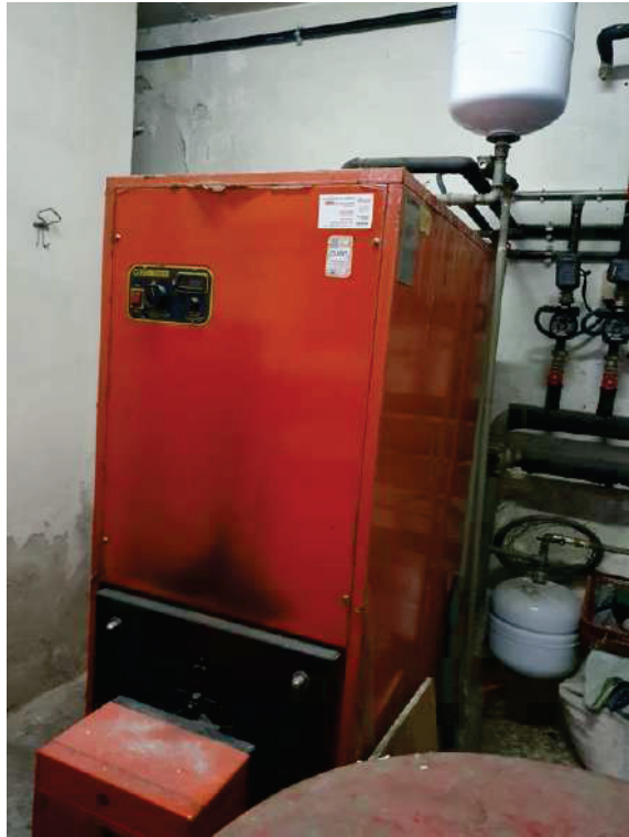
Fotografia E.55 - Centrale termica: bcnc sub.3_c
