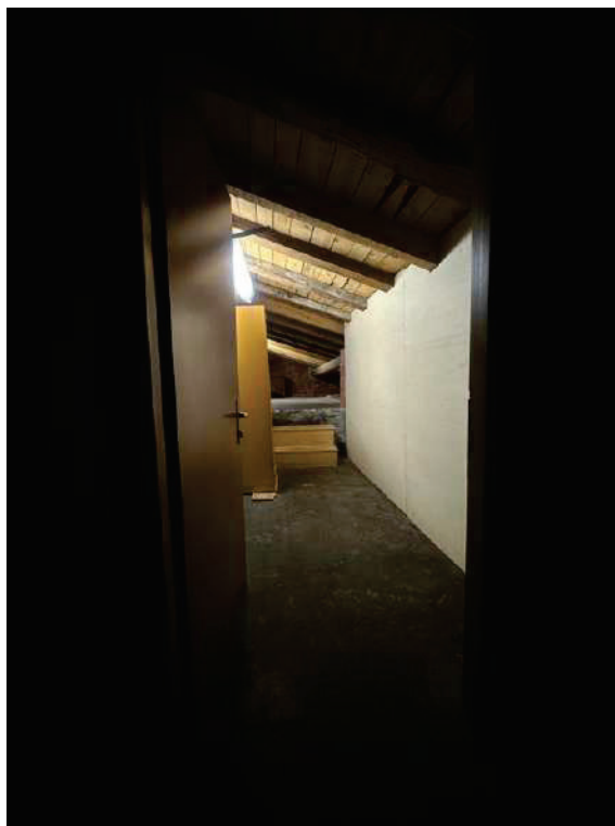
Fotografia E.43 - Solaio sottotetto sub.16 - Prima della modifica della dividente
