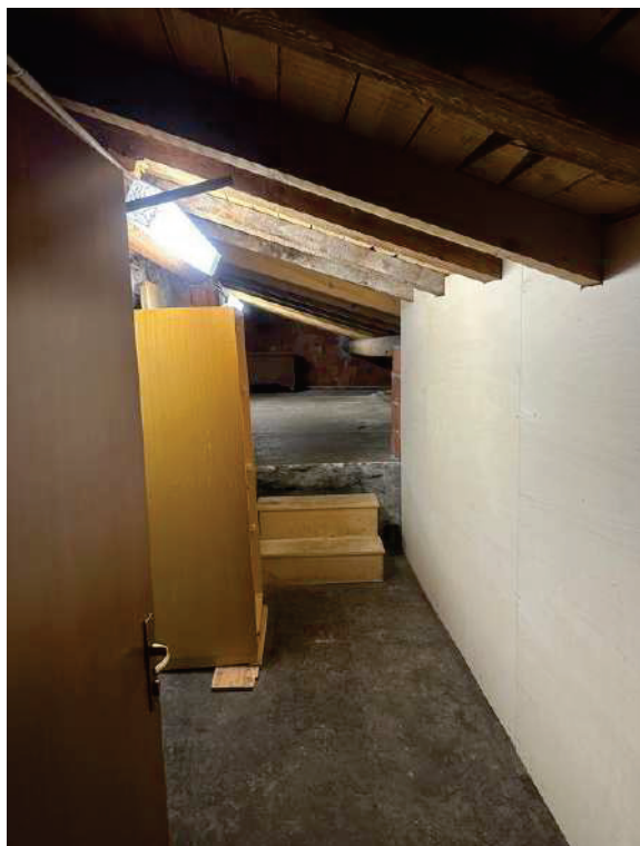
Fotografia E.44 - Solaio sottotetto sub.16 - Prima della modifica della dividente
