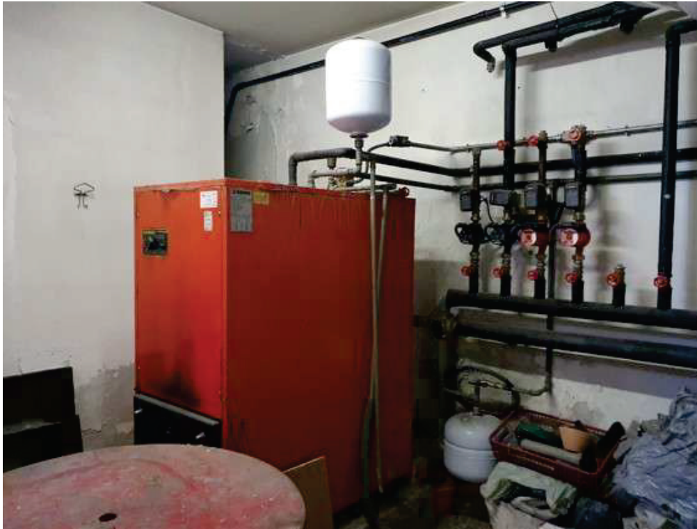
Fotografia E.57 - Centrale termica: bcnc sub.3_e
