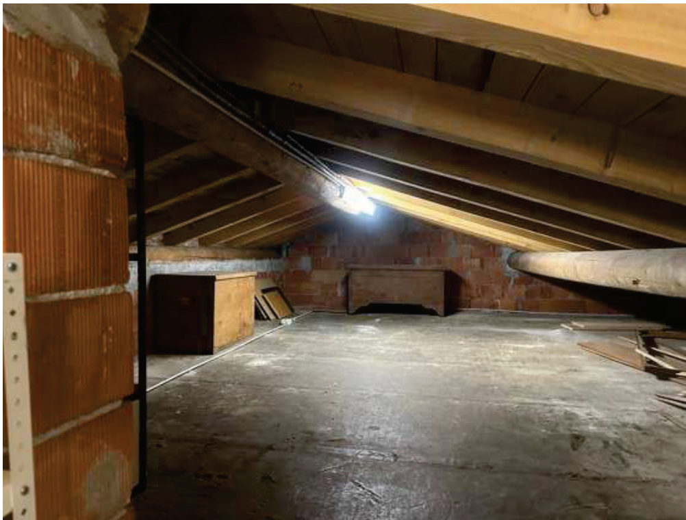
Fotografia E.46 - Solaio sottotetto sub.16 - Prima della modifica della dividente
