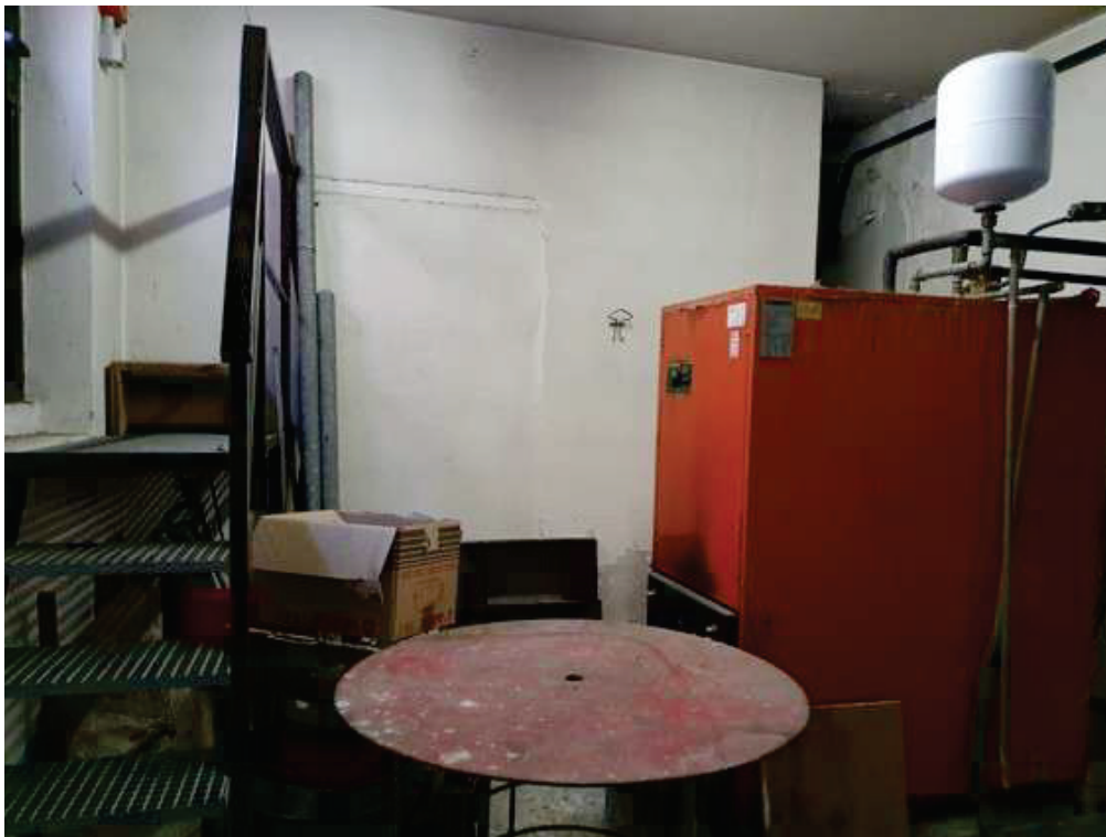
Fotografia E.56 - Centrale termica: bcnc sub.3_d
