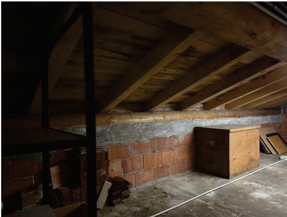
Fotografia E.48 - Solaio sottotetto sub.16 - Prima della modifica della dividente
