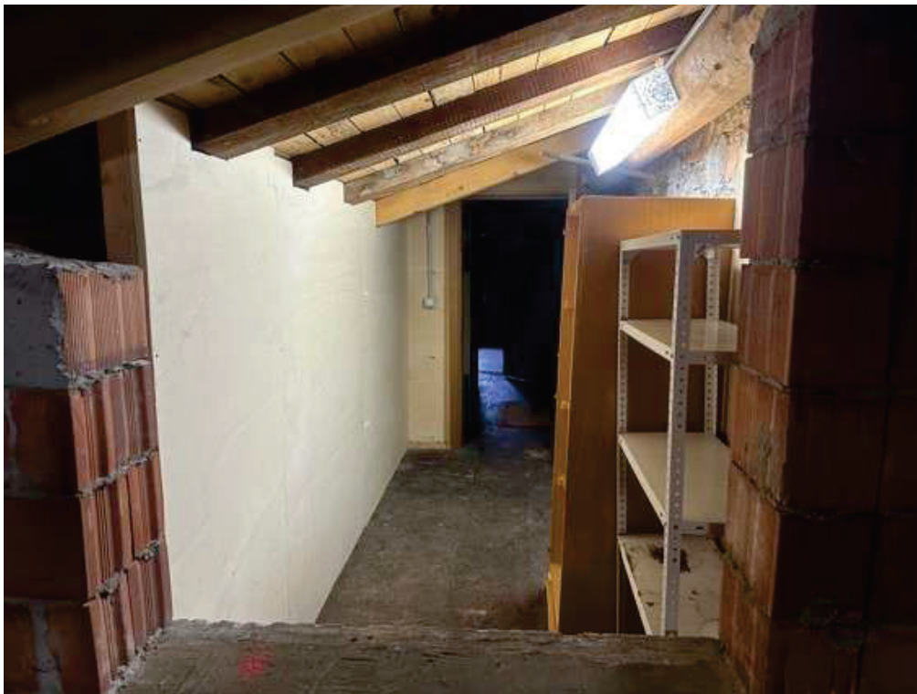
Fotografia E.50 - Solaio sottotetto sub.16 - Prima della modifica della dividente
