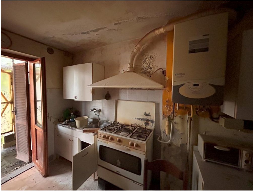
Piano Terreno - Dettaglio cucina e danni da infiltrazioni
