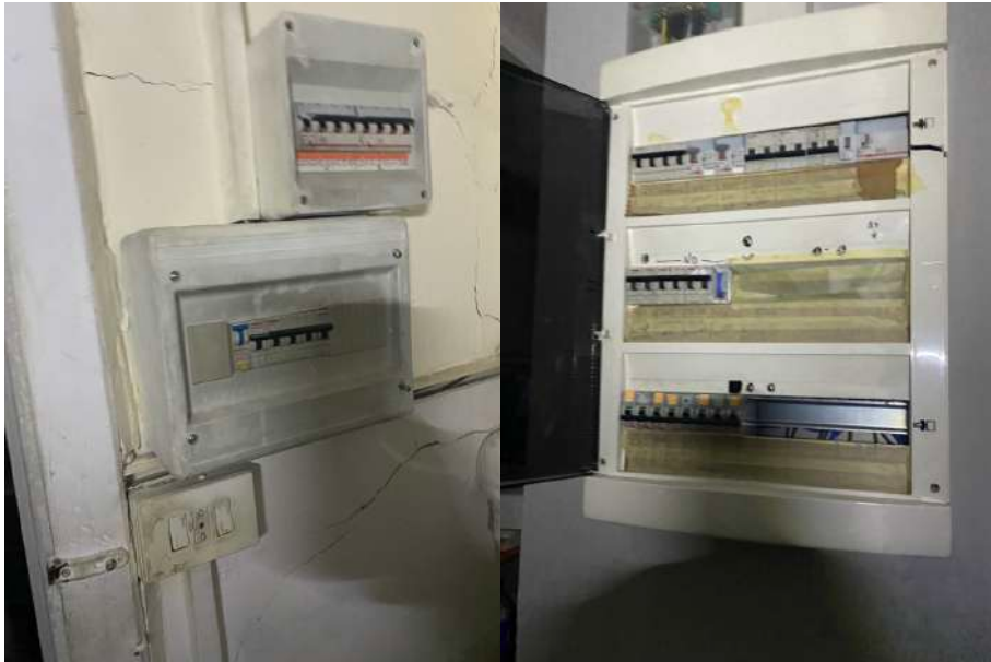
Foto da 41 a 42: Vista quadri elettrici
