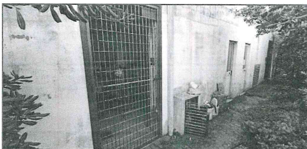
FOTO 44 LOCALI TECNICI INGRESSI
