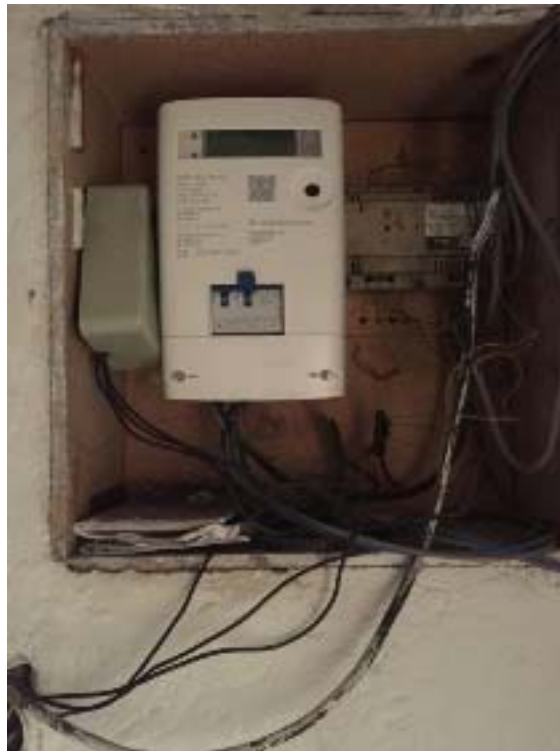
Bisignano (CS) – via Principe di Piemonte - Foglio 39, Particella 219 impianti comuni
