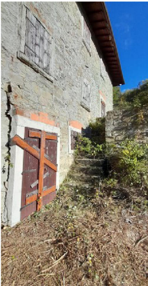
F.02 Particolare distacco Porta
