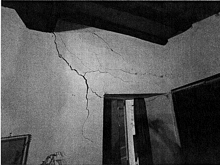
Foto n. 19, vista delle lesioni strutturali a piano primo lato sud ovest;
