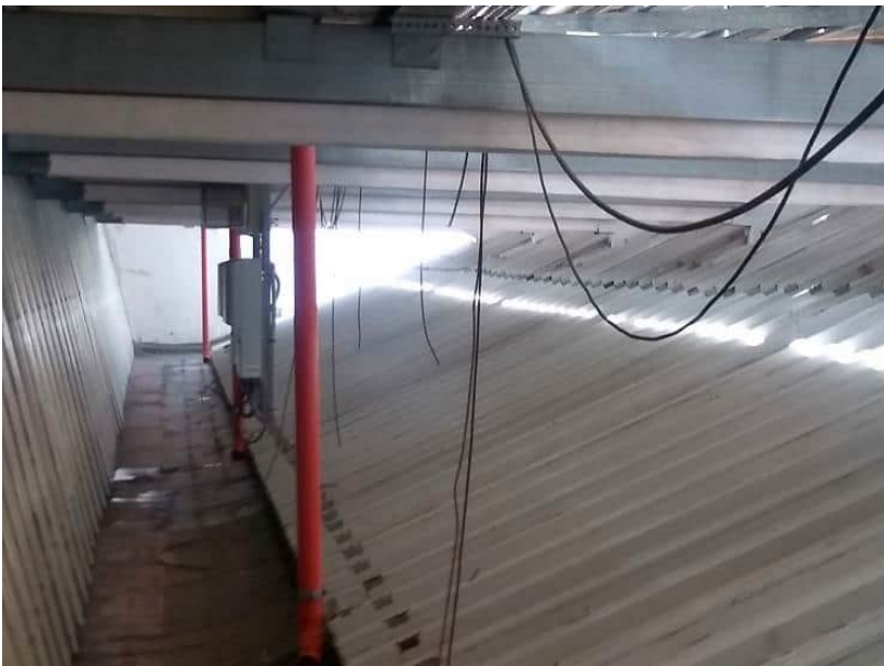
Figura 10: Cavi solari ai quadri stringa interrotti
