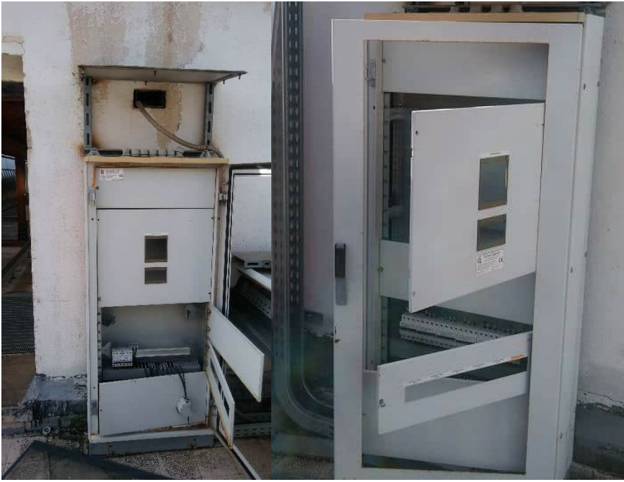
Figura 11: Quadro con interruttore e cavi asportati
