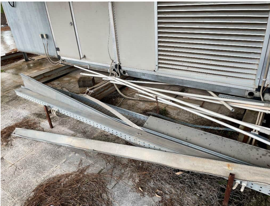
Figura 12: Canaline e tubazioni danneggiate
