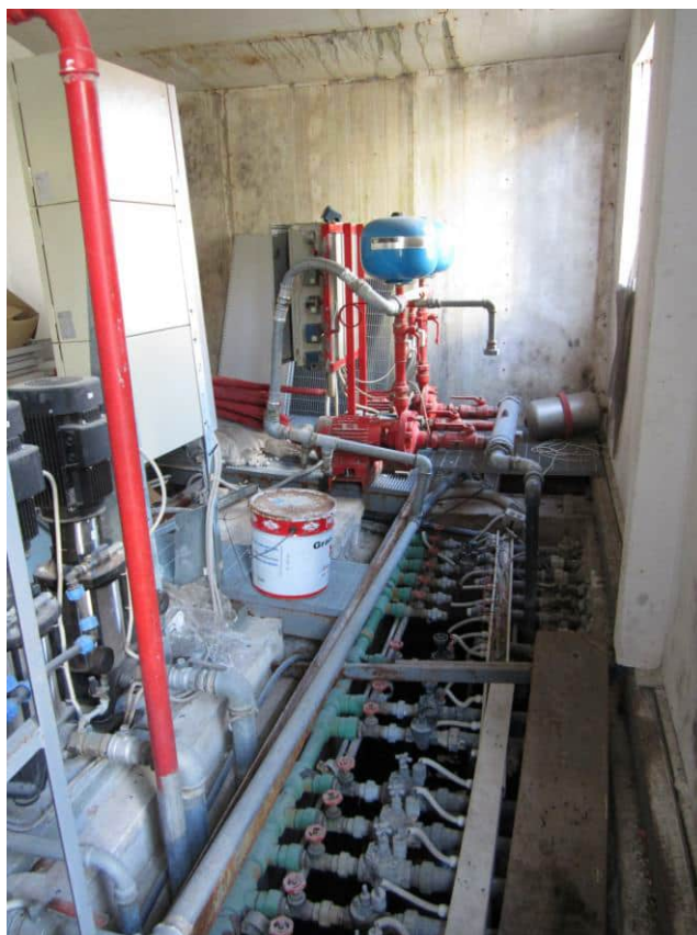
Foto 91: gli impianti idrici all'interno del box in legno, indicato con il n. 2 nella planimetria catastale
