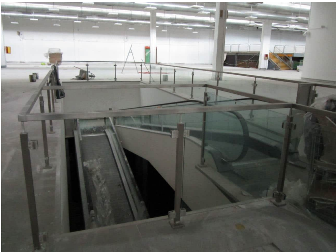
Foto 14: inquadratura del tappeto mobile di collegamento al piano cantinato, realizzato nella zona centrale dell'area di vendita
