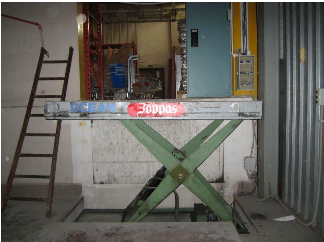
Foto 24: il sistema di sollevamento che collega l'area sottostante la "zona soppalcata" al magazzino di cui alla precedente foto 16
