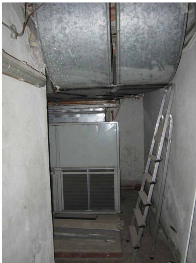
Foto 37: uno dei locali tecnici ubicati al piano cantinato
