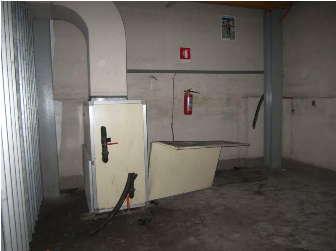
Foto 23: un vano tecnologico limitrofo all'area sottostante la "zona soppalcata",
