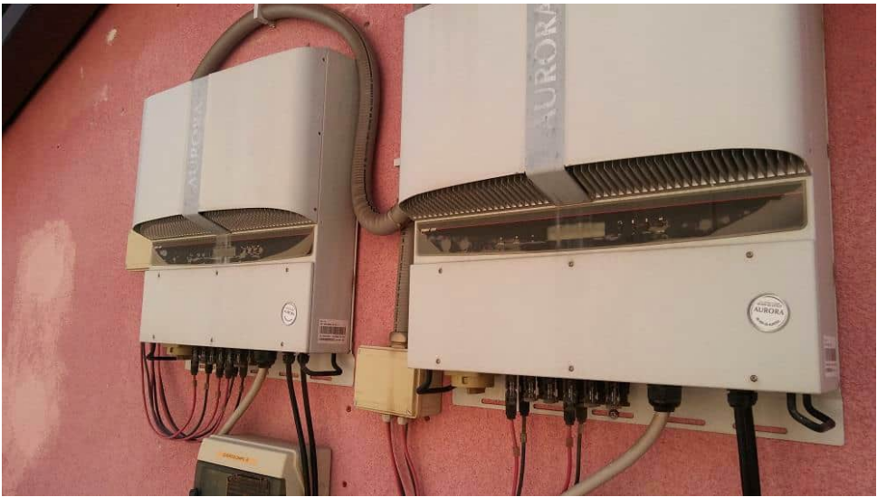
Figura 5: particolare impianto: inverter
