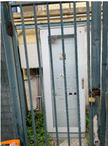
Figura 2: quadro impianto con dispositivo interfaccia
