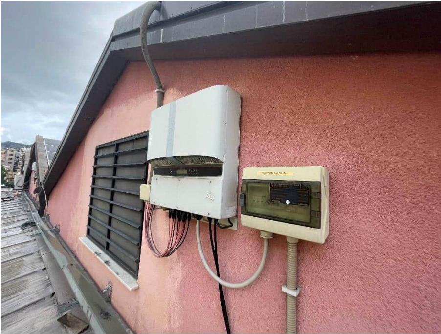
Figura 6: particolare impianto: inverter
