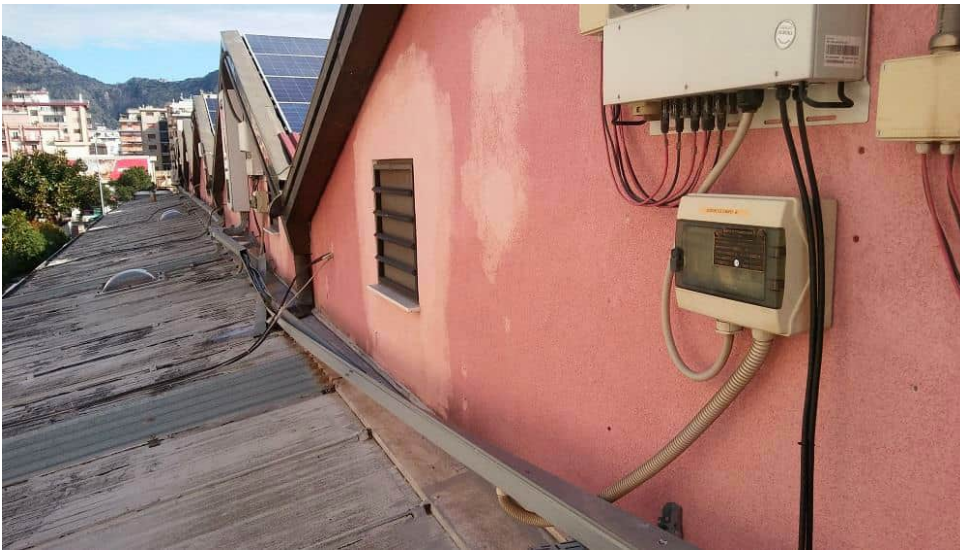
Figura 7: accesso alle falde con canaline danneggiate
