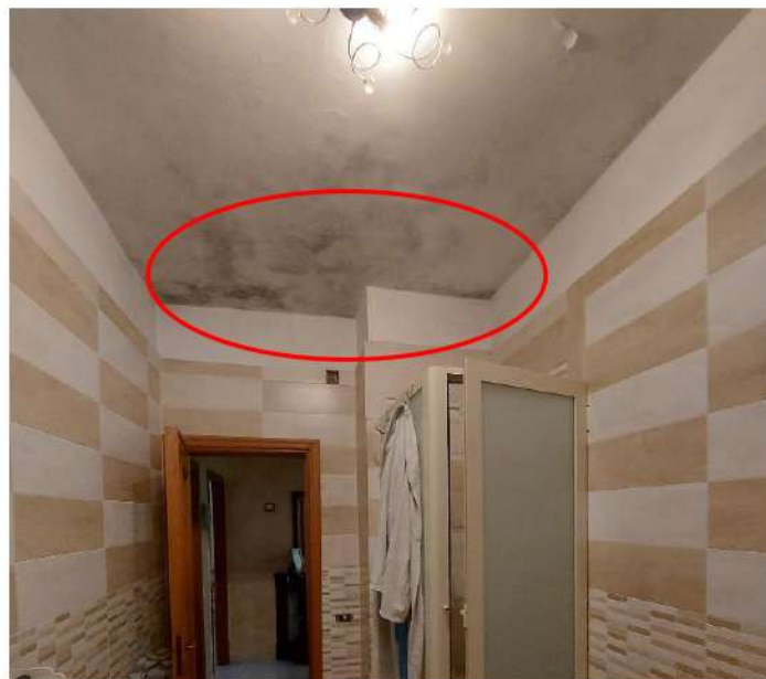
Locale bagno – indicazione presenza fenomeni umidità
