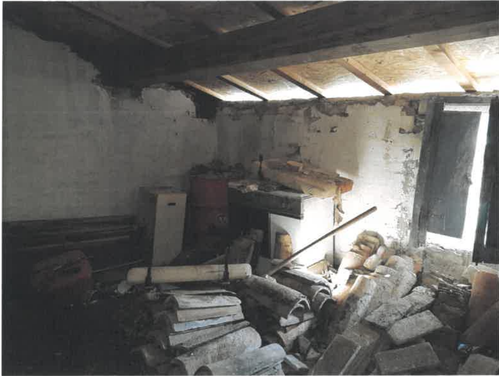
Foto 04 – Unità collabente (interni abitazione)
