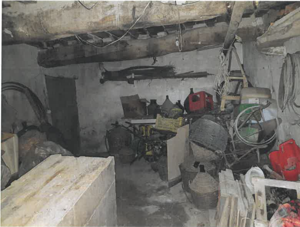
Foto 02 – Unità collabente (interni cantine)
