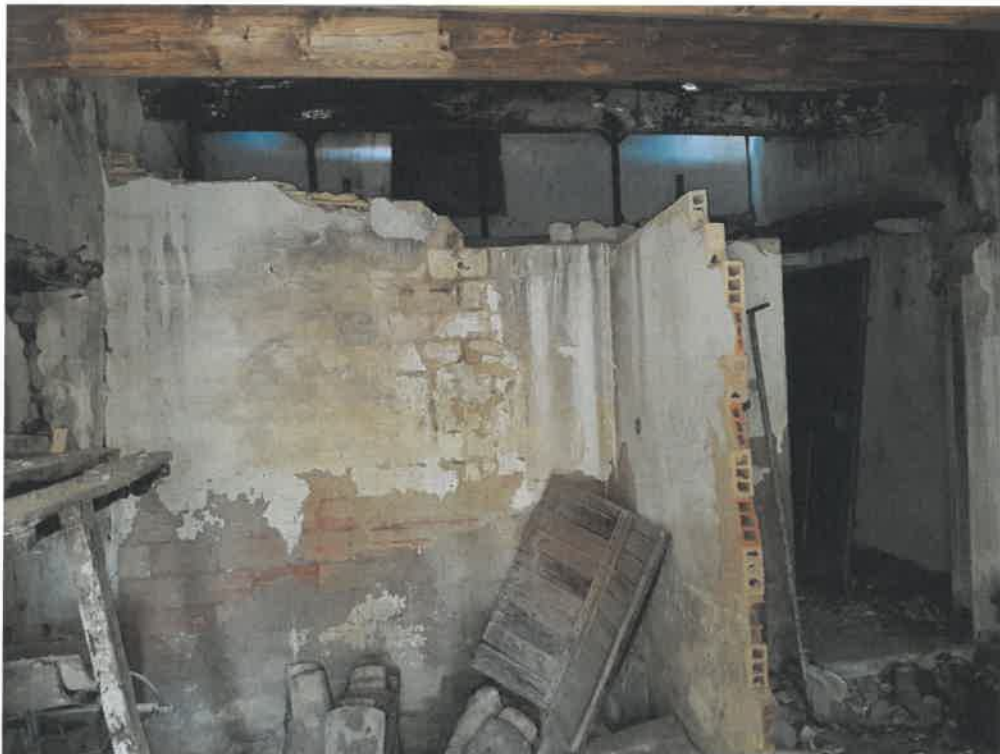
Foto 03 – Unità collabente (interni abitazione)
