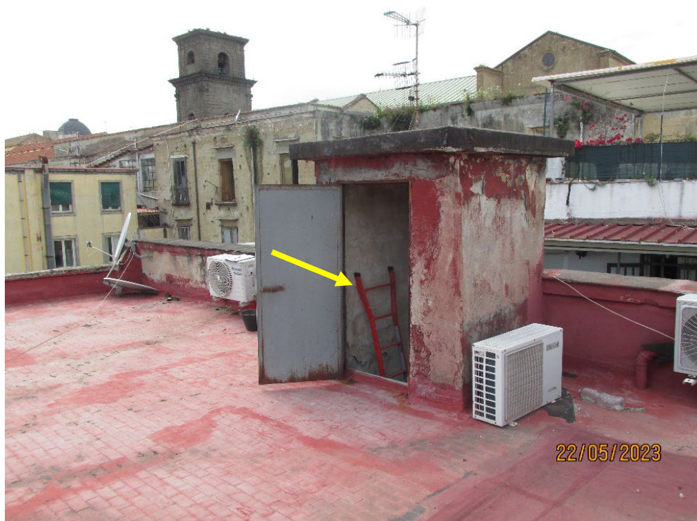
Fotografia 55 – Lastrico Solare: il torrino in muratura è dotato di due serramenti in ferro di protezione, uno installato alla base, quindi sul ballatoio, e l’altro installato al vertice, quindi sul terrazzo.
