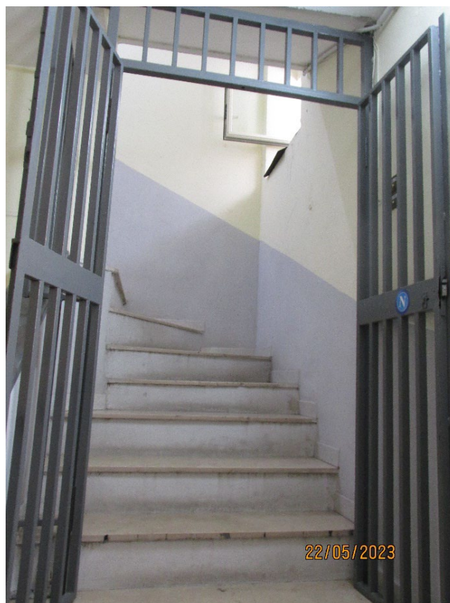
Fotografia 22 – Altra immagine del serramento in ferro a due ante installato sul ballatoio prima di raggiungere il terzo piano.
