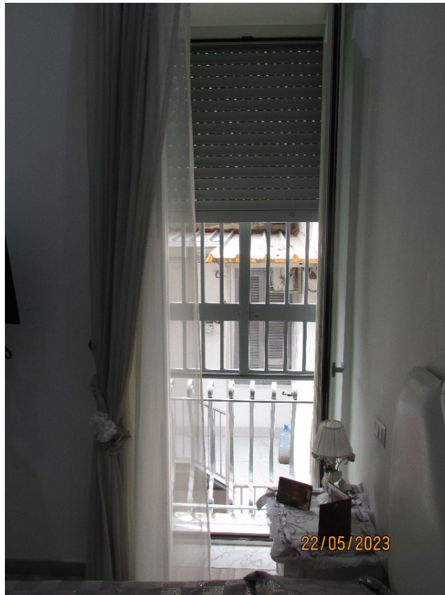
Fotografia 29 – Vano 1: L'ambiente è dotato di una porta-finestra con oggetto alla "romana" da cui prende aria e luce, protetta esternamente da una inferriata, la stessa affaccia sul cortile condominiale del fabbricato del civico 43, l'apertura è munita di infisso in alluminio con vetri camera.
