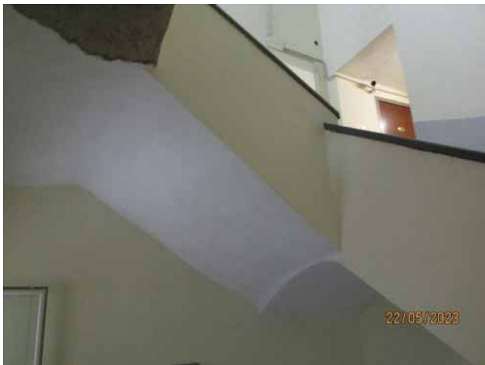
Fotografia 17 – La struttura della scala è costituita in muratura portante protetta esternamente da un muretto sprovvisto di corrimano.
