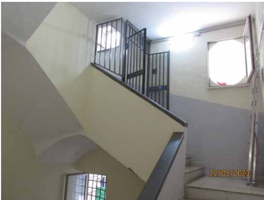
Fotografia 21 – Poco prima di raggiungere il terzo piano, in prossimità del penultimo ballatoio della scala condominiale è installato un cancello costituito da una struttura con grate in ferro munita di serramento a due ante.
