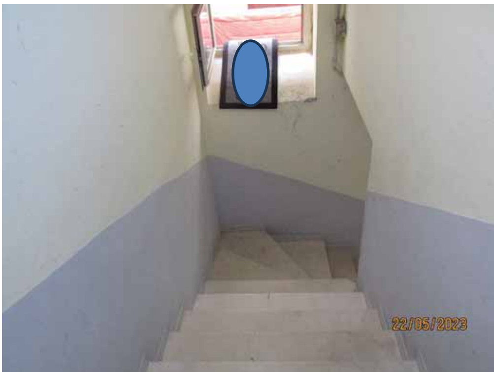
Fotografia 19 – Le pedate fino dal secondo ballatoio in avanti, sono rivestite con lastre in marmo; le pareti del vano scala sono rivestite con intonaci ordinari a finitura liscia e tinteggiate con pittura al quarzo.
