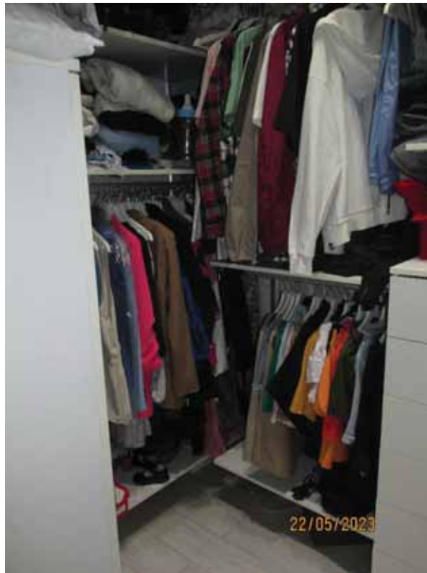
Fotografia 44 – Vano 4: La pavimentazione è costituita da piastrelle in gres porcellanato; le pareti rivestite con intonaci ordinari a finitura liscia e tinteggiate con pittura lavabile; il soffitto rivestito con intonaci ordinari a finitura liscia e tinteggiato con pittura a tempera. L’ambiente non dispone di finestra verso l’esterno.
