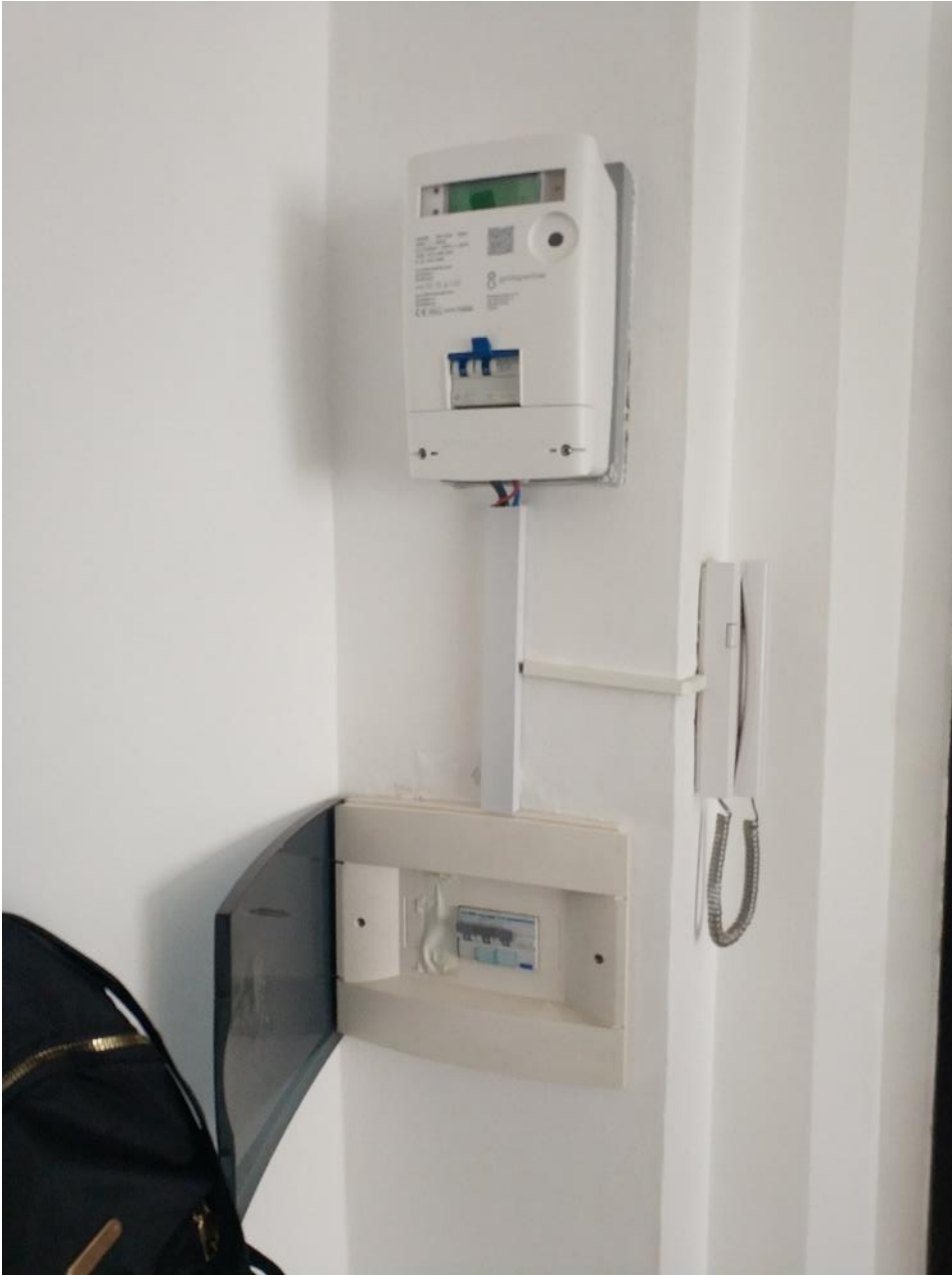
Figura 4. Quadro elettrico e contatore generale (non sono presenti certificazioni degli impianti)
