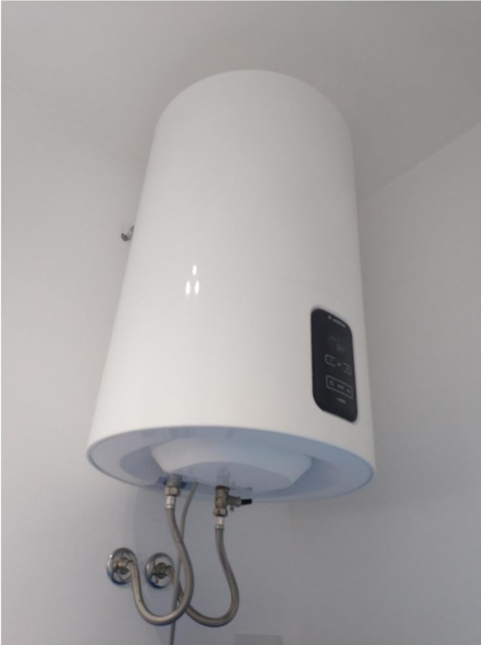
Figura 13. Vista del boiler elettrico per la produzione di acqua calda sanitaria
