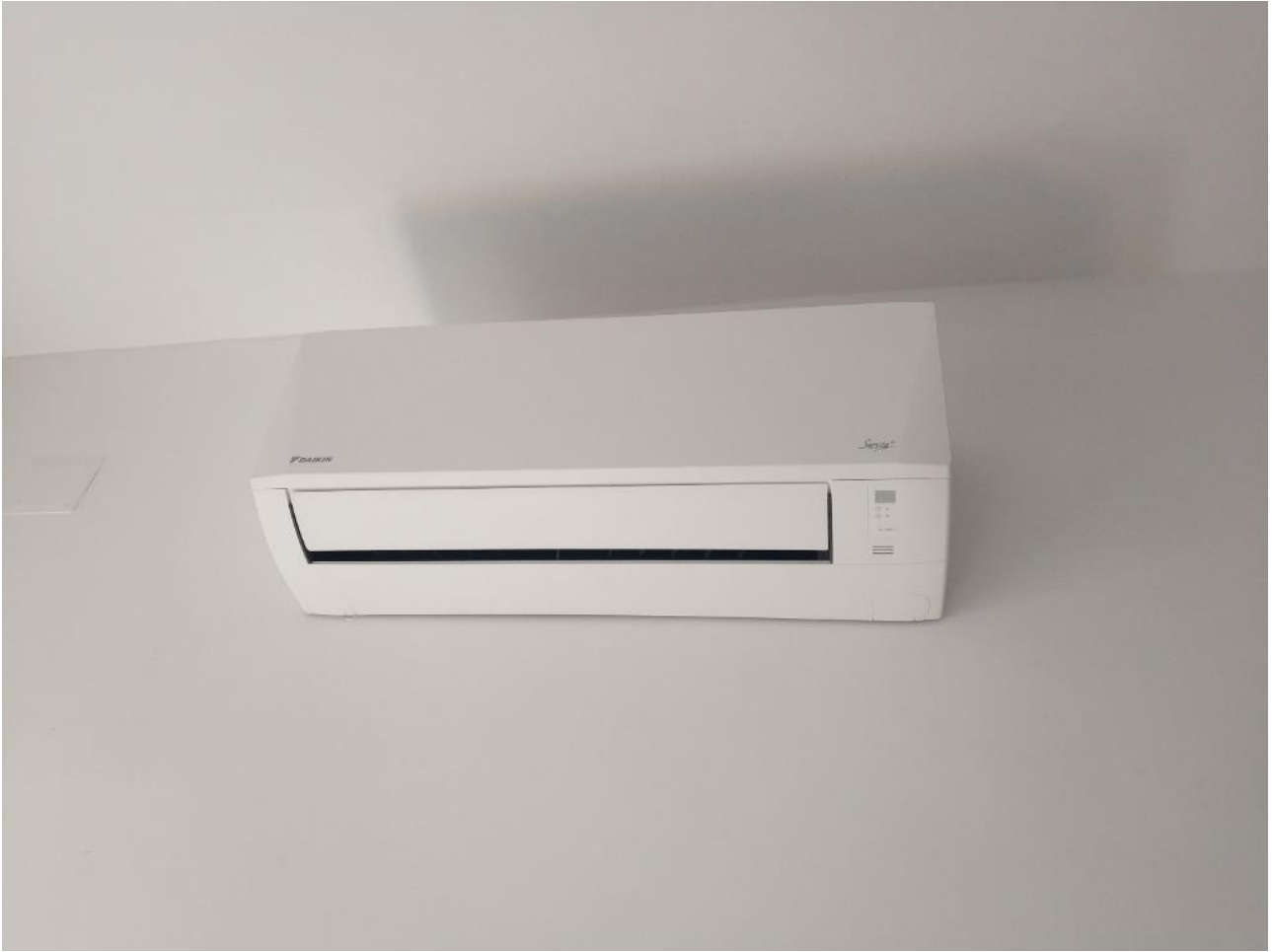
Figura 8. Vista dell'unità split montata sul locale soggiorno
