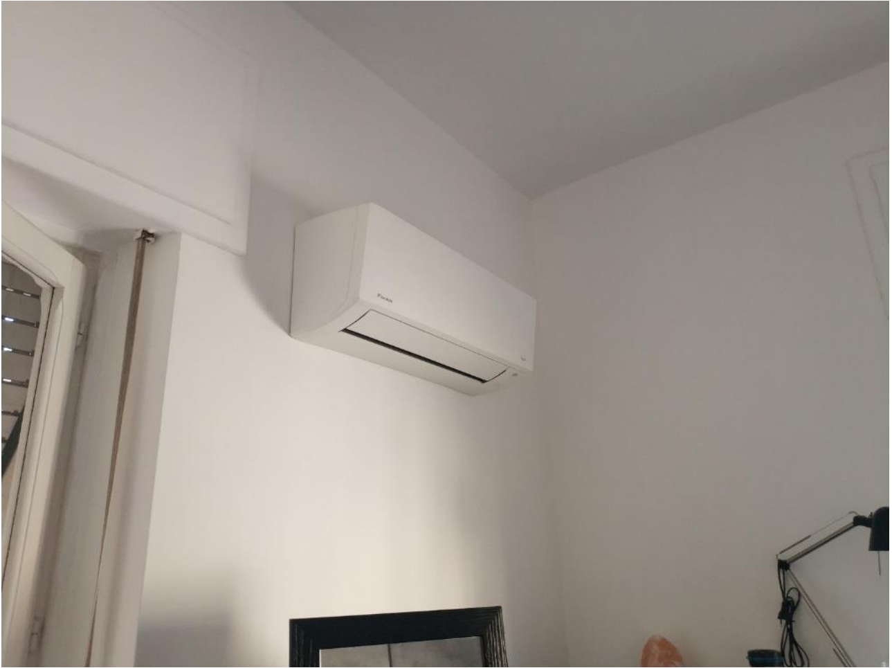
Figura 25. Vista dell'unità split montata sul locale camera da letto
