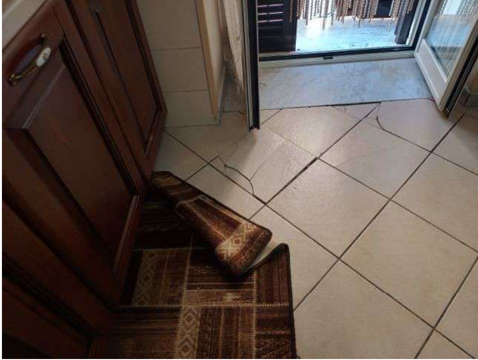
FOTO N. 9 – Dettaglio di piastrelle del pavimento danneggiate nel vano soggiorno - pranzo
