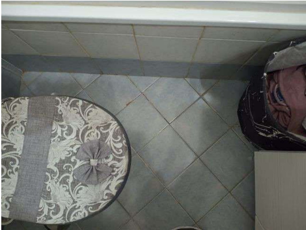
FOTO N. 13 – Dettaglio delle piastrelle del pavimento danneggiate nel bagno
