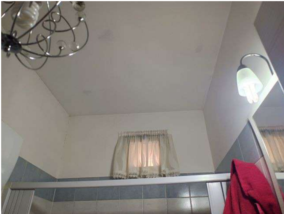
FOTO N. 16 – Dettaglio del soffitto del bagno con intonaco ammalorato
