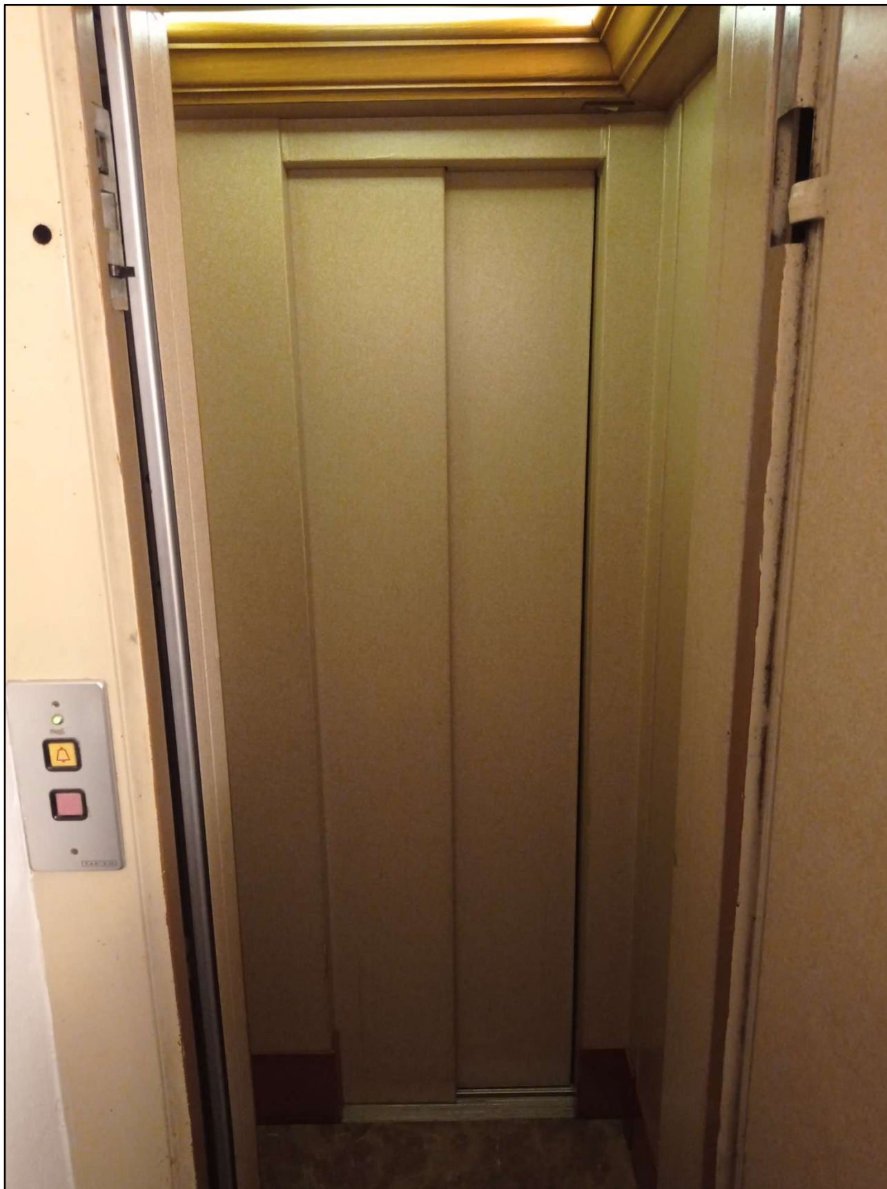
Foto 22: interno cabina ascensore
