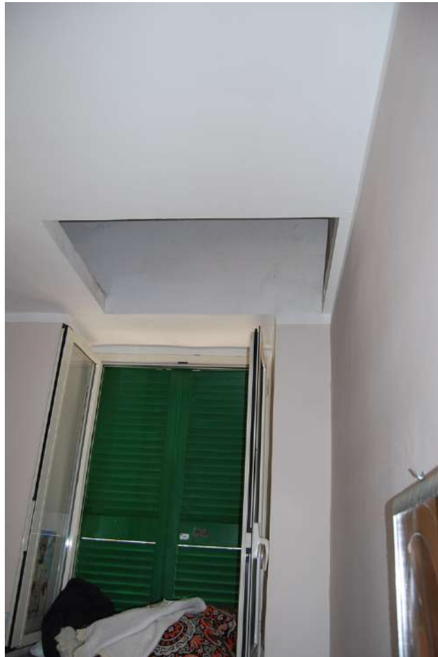
FOTO 16 PARTICOLARE BOTOLA SOPP./DEP. LETTO U. IMMOBILIARE PORZIONE 2
