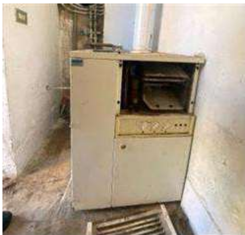
Caldaia fuori uso
