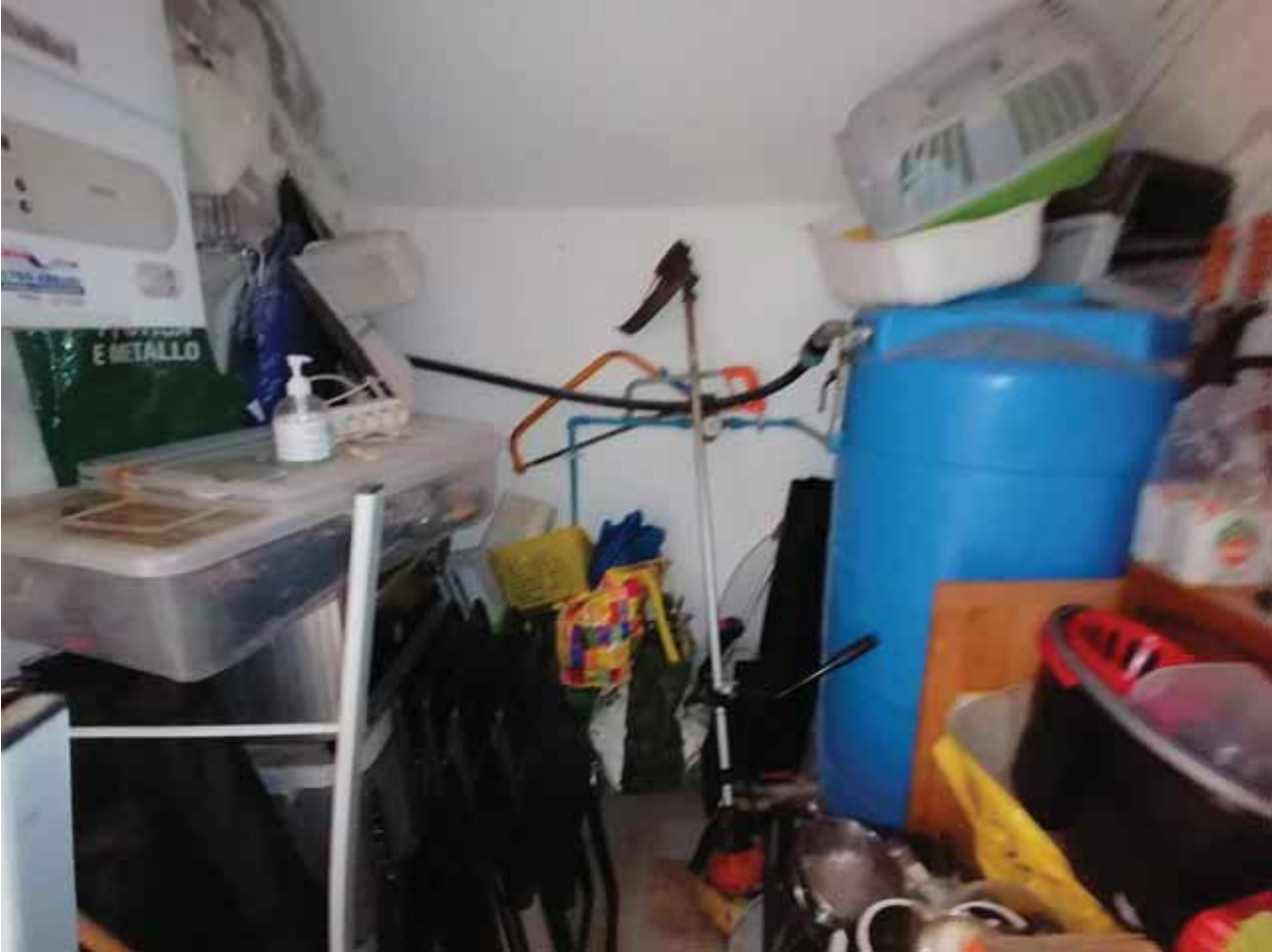
FOTO N°25: Vista interna del locale caldaia al piano seminterrato (1/2).
