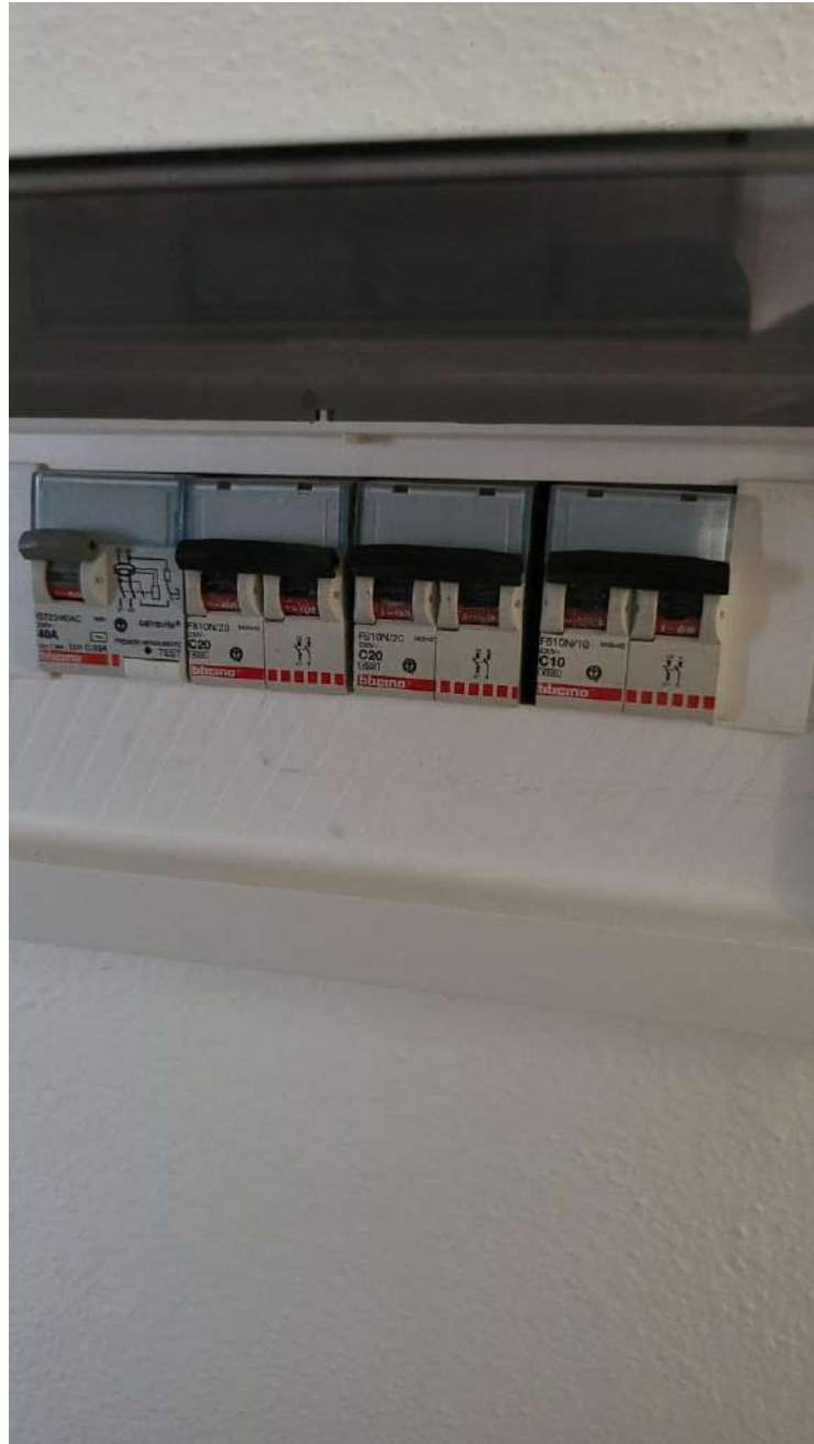
Foto 26: il quadro elettrico
