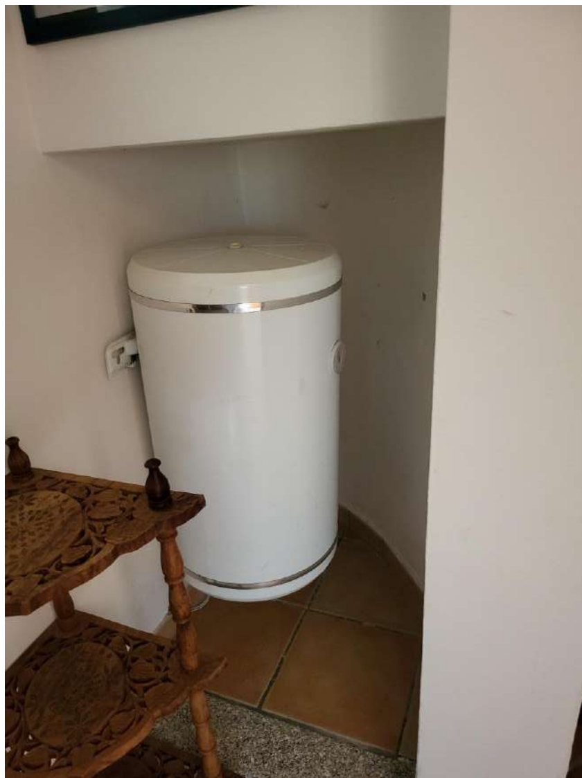
Foto 27: il Boiler elettrico
