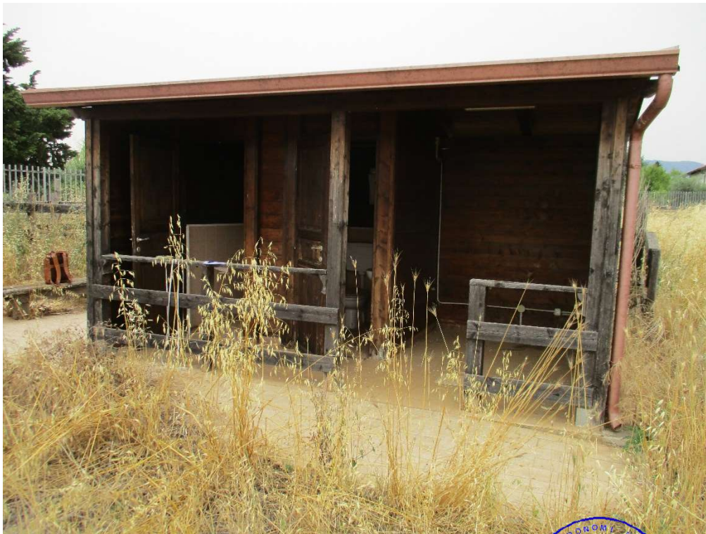
Foto 2 – Struttura in legno con servizi igienici - non autorizzata
