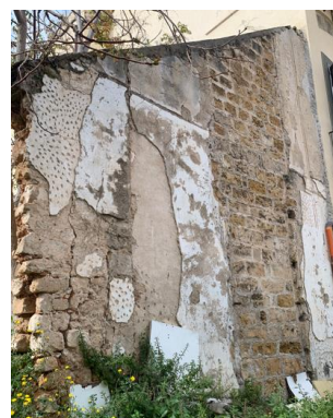
Foto 10 resti muro comune unità 839 e 845
