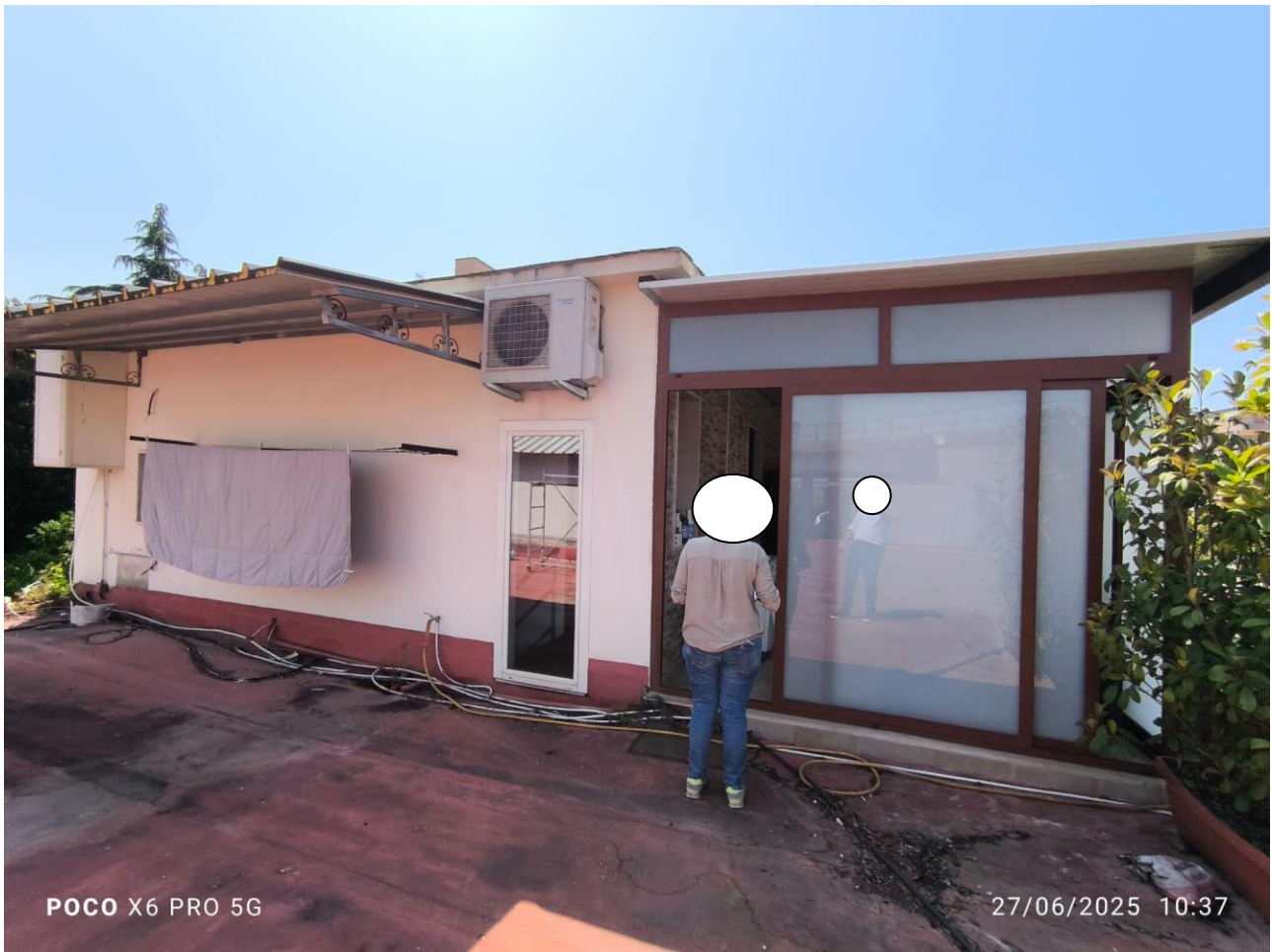
FOTO N. 24: Unità immobiliare, non oggetto di pignoramento, realizzata sull'estradosso della copertura e avente unico ed esclusivo accesso dall'interno del capannone mediante la scala in ferro.
