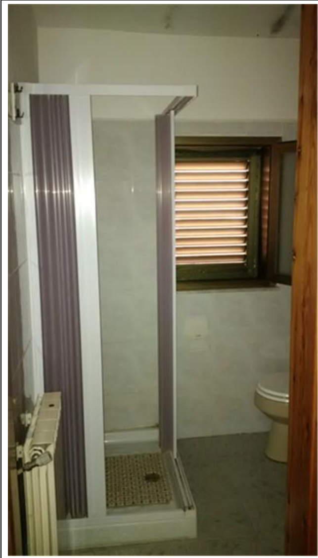
Foto 29- bagno/wc abusivo, 1° piano
