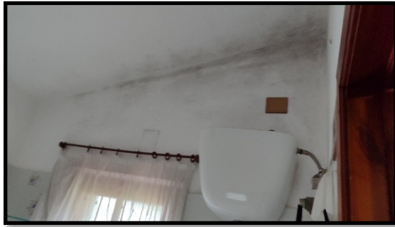
Infiltrazioni dal tetto al piano 1°
