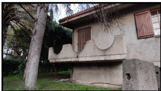
Balconi senza protezioni
