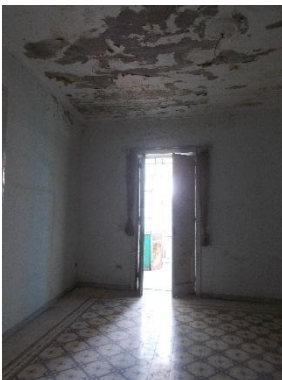
Soffitto della seconda camera
