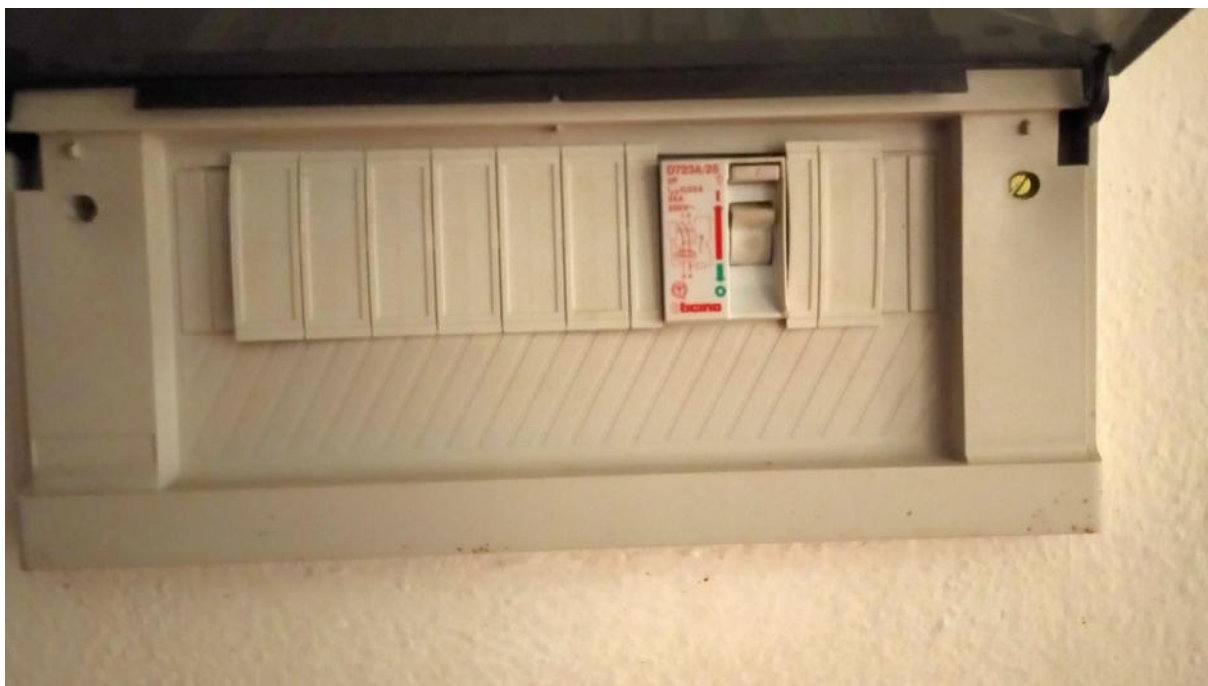
FOTO 15: : Vista impianto elettrico
