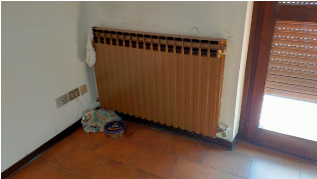
FOTO 18: : Vista impianto termico- elemento radiante
