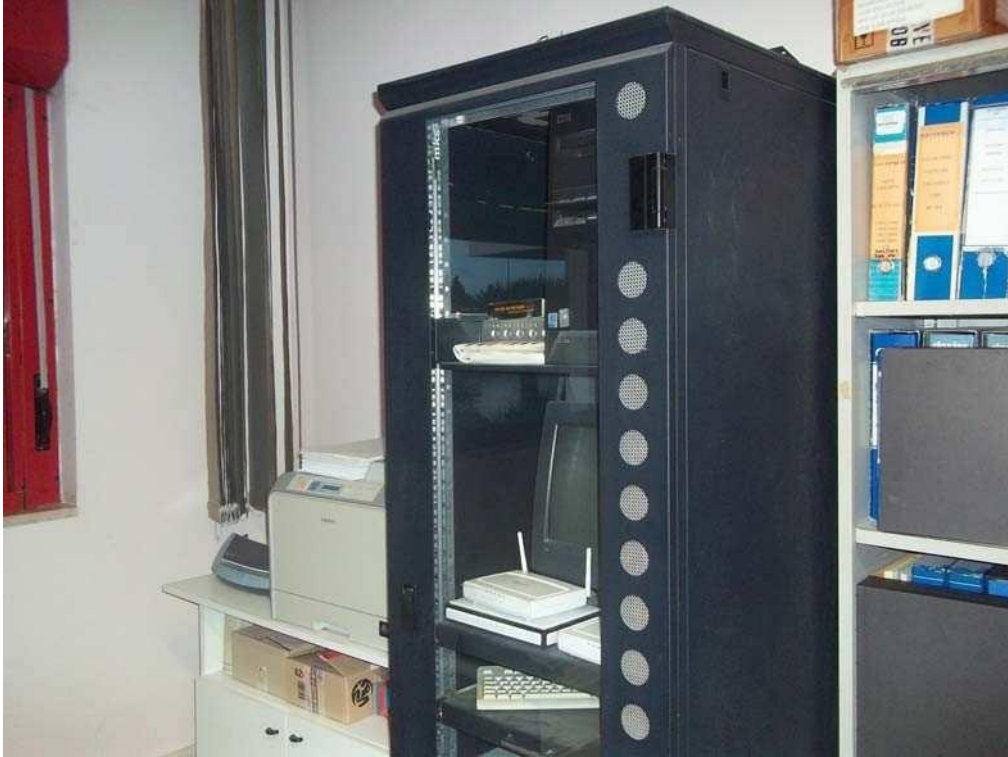
Foto n. 204: armadio rack completo di server
