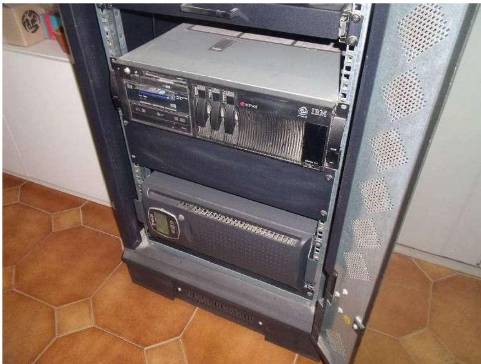
Foto n. 92: server IBM completo di gruppo di continuità
