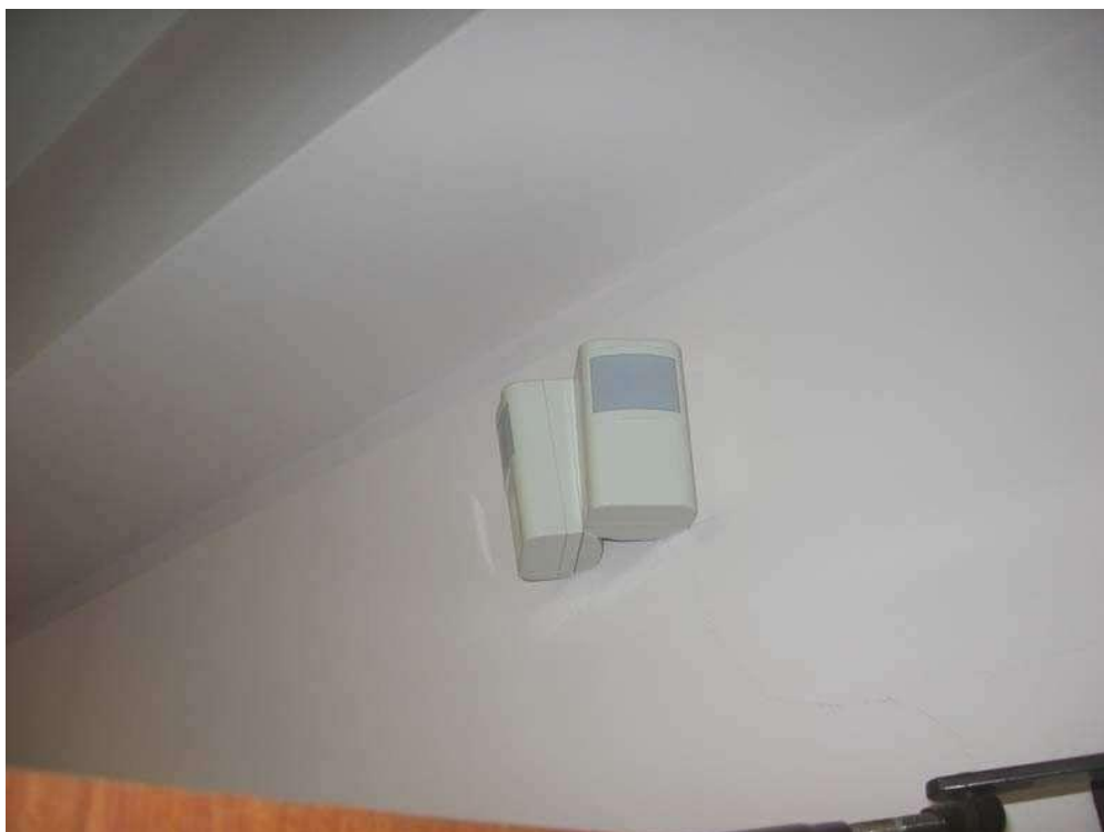
Foto n. 216-bis: rilevatori impianto di allarme
