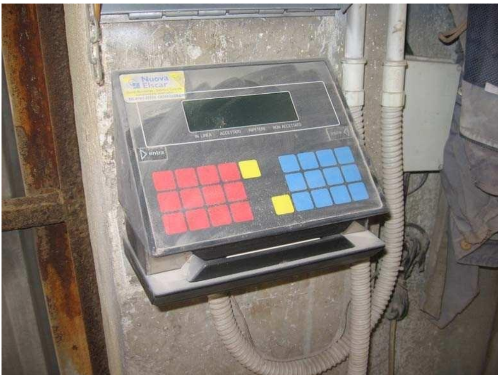
Foto n. 214: terminale rilevatore (ingresso Ovest capannone 1)
