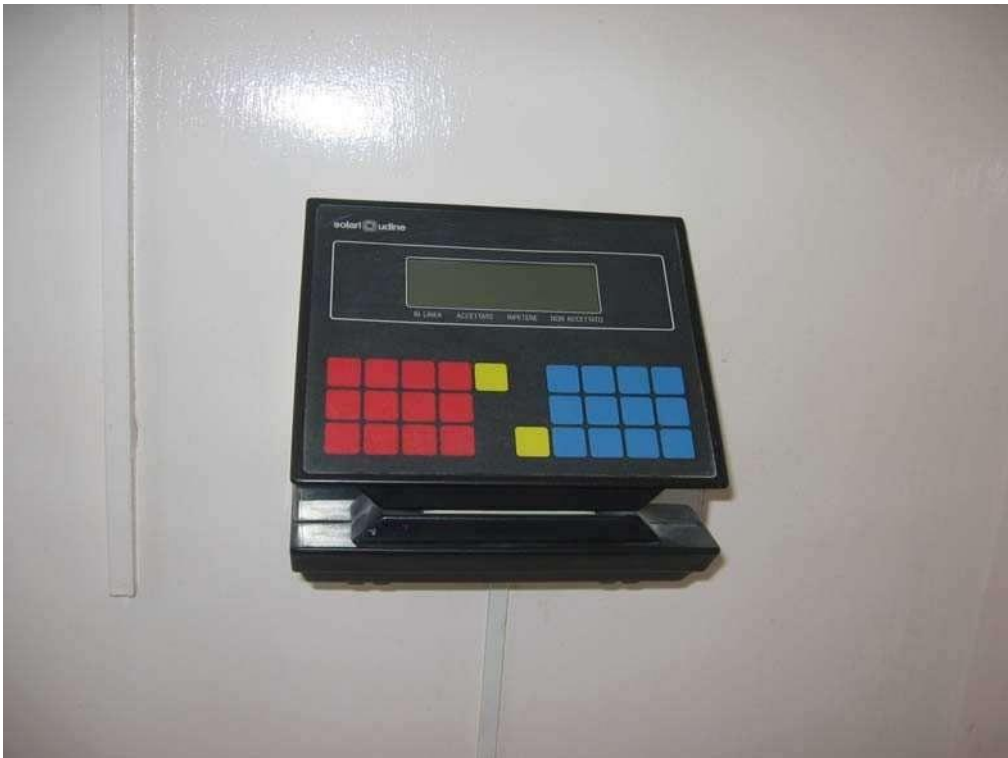
Foto n. 214-bis: terminale rilevatore (ingresso uffici)
