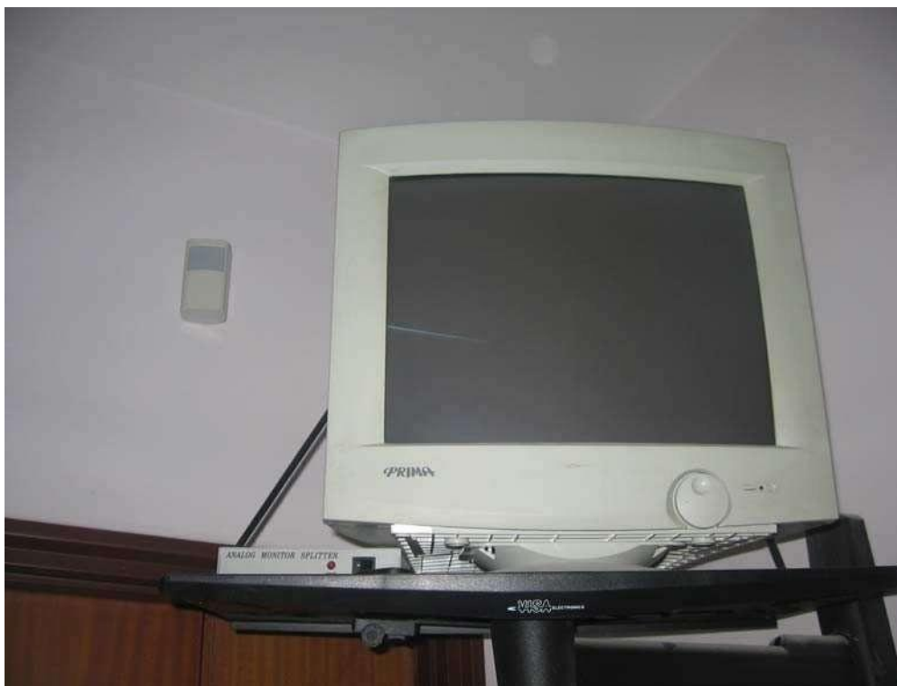
Foto n. 216: impianto di allarme
