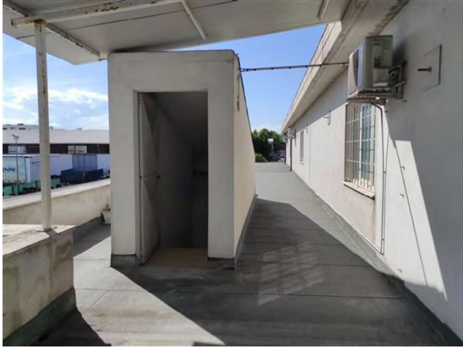
Lotto 2 – Accesso al piano primo su lastrico solaio e tettoia abusiva
