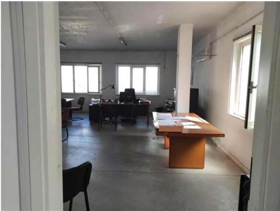
Lotto 2 – Vista interno locale (tiranti pilastri-tamponamento)
