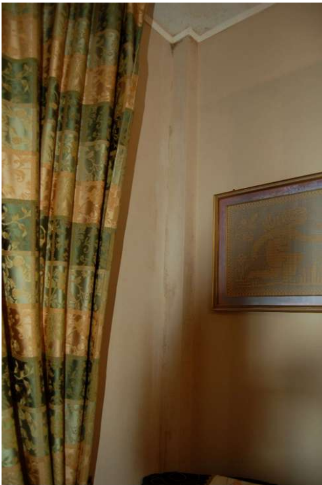
Foto 22 - Fenomeni di degrado causati da condensa superficiale
