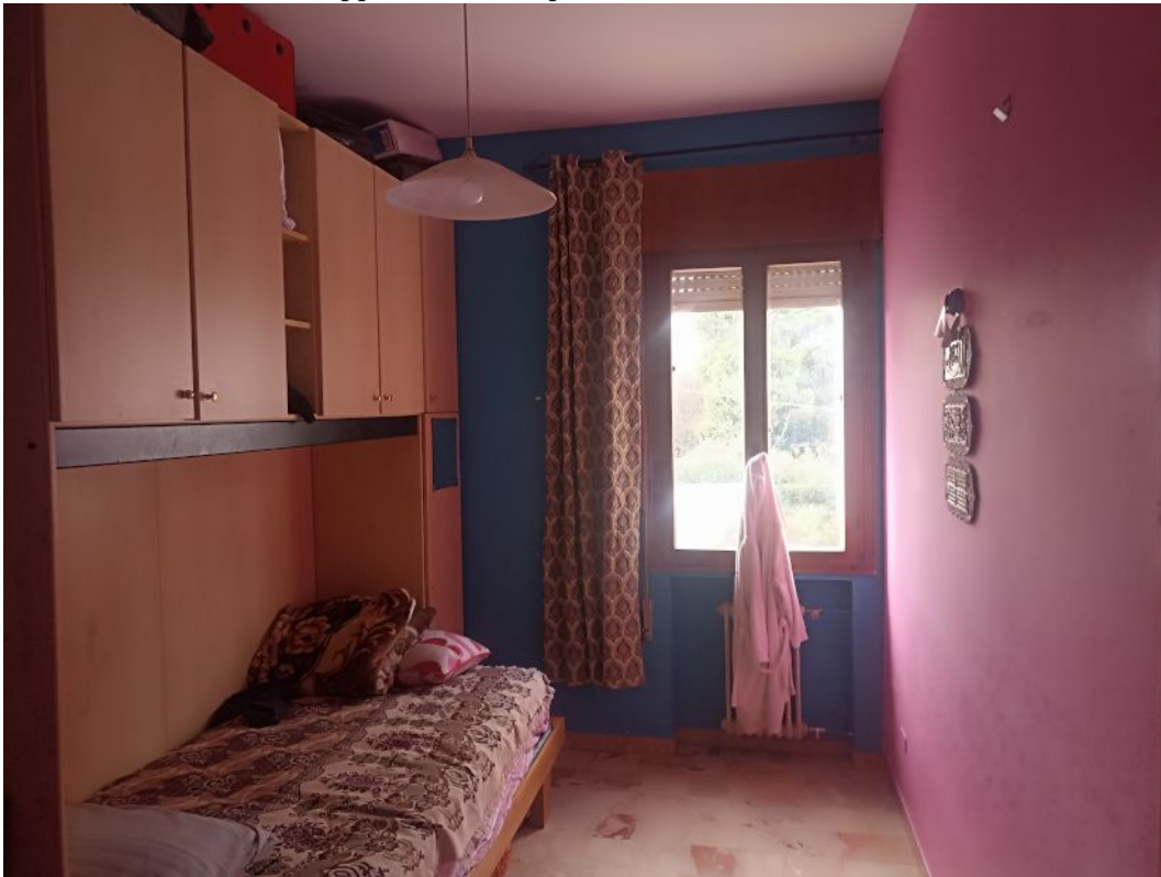
Foto 8 – infiltrazione dall'appartamento superiore che risulta risolta
