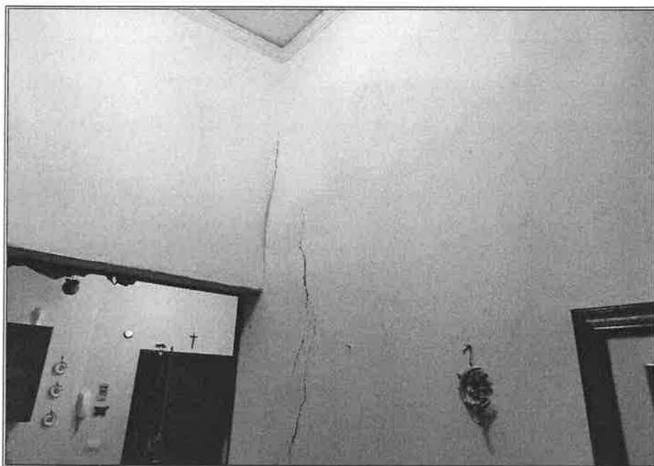
11 - Particolare lesione interna in corrispondenza del disimpegno
