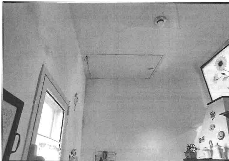
18 – Scala retrattile bloccata e parete con infiltrazioni d'acqua
