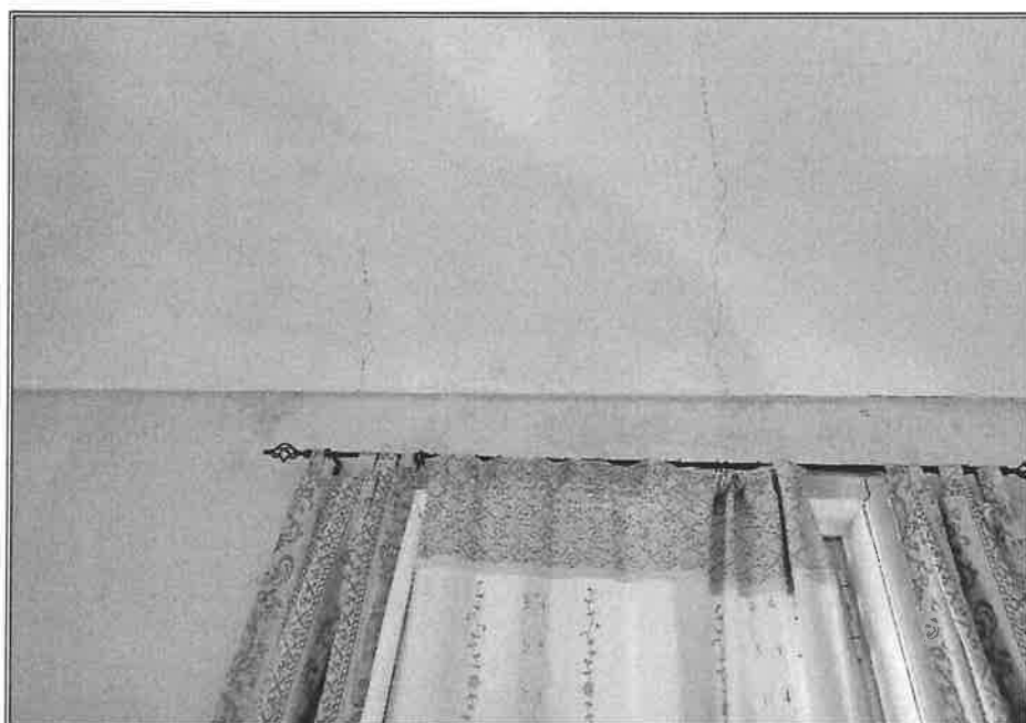
16 - Lesione e infiltrazioni d'acqua soffitto camera 2
