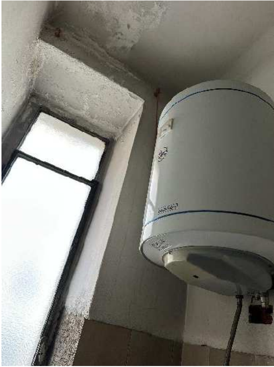
13. Dettaglio del boiler elettrico nel bagno.
