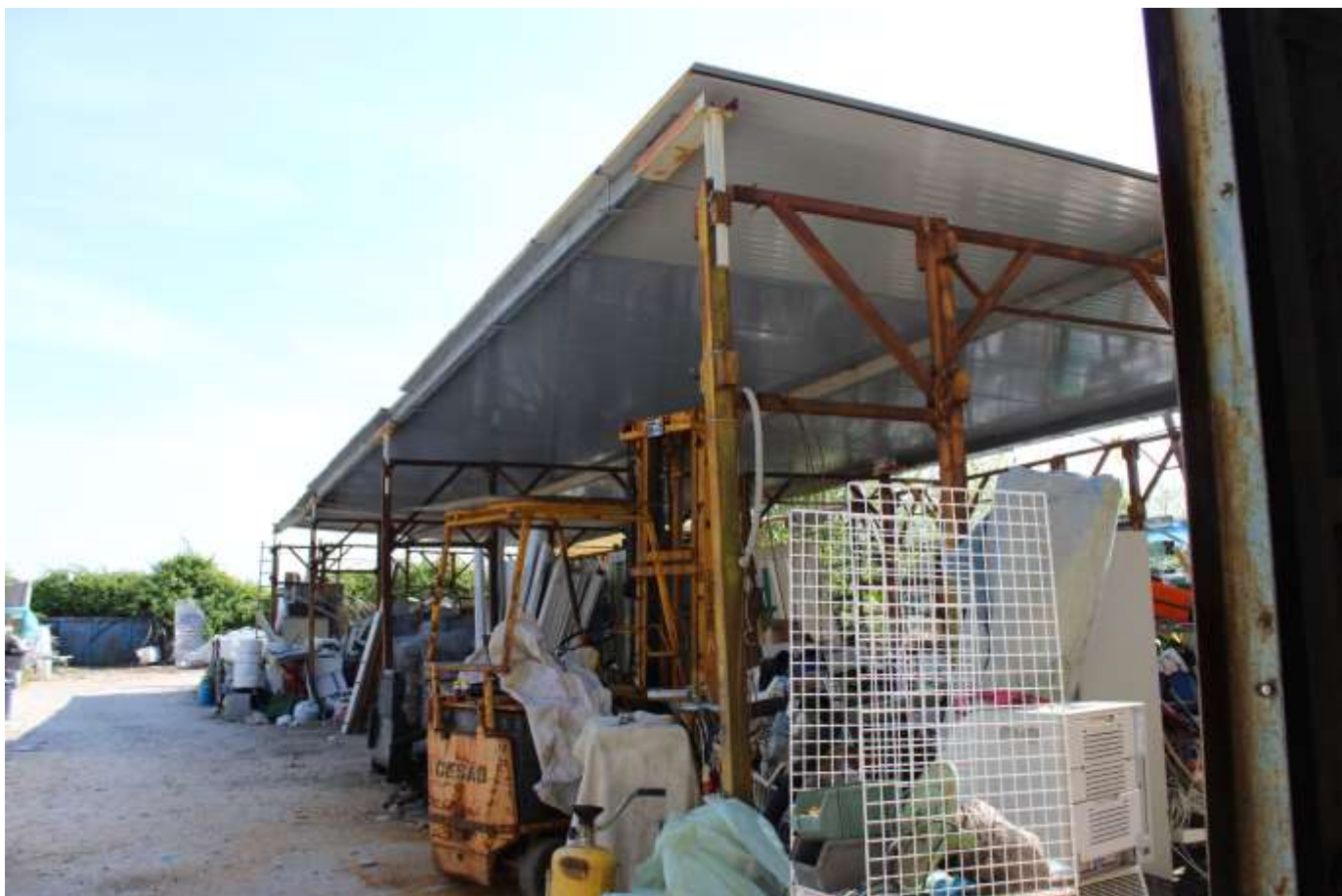
Tettoia nella corte esterna (sub 21) non autorizzata
