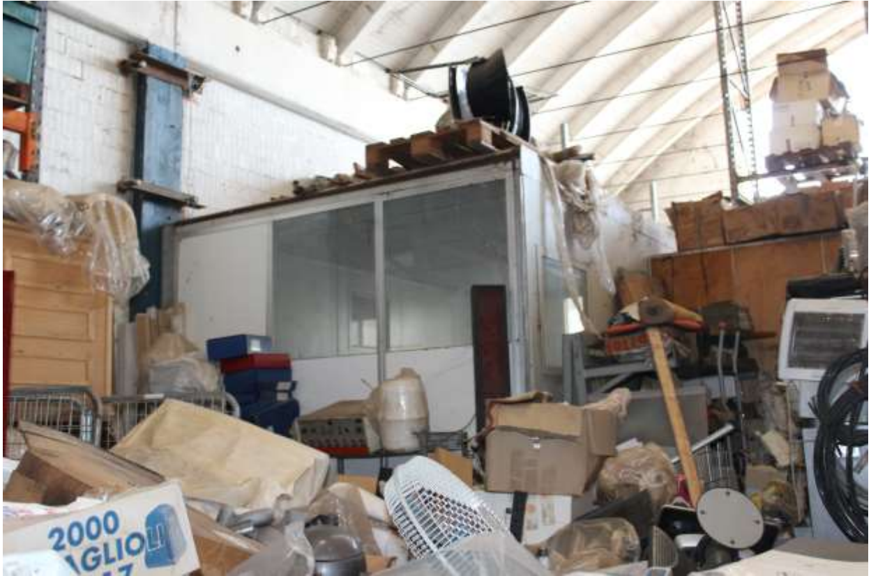
Un prefabbricato interno (non autorizzato) (sub 12)
