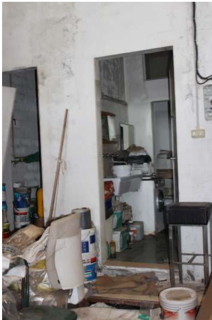
Servizi igienici (sub 12)
