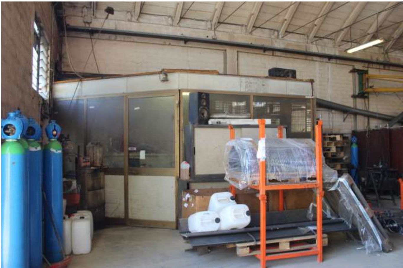
Un prefabbricato interno (non autorizzato) (sub 11)
