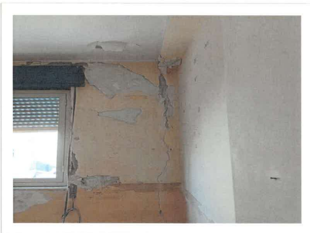
Foto n.ro 34: dettagli ammaloramenti stanza da letto piccola
