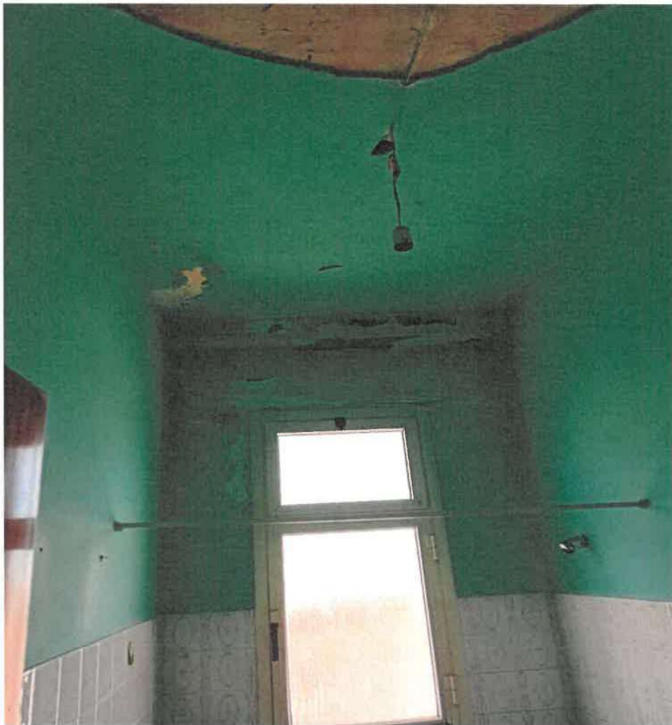
Foto n.ri 31-32 : soffitto locale bagno
