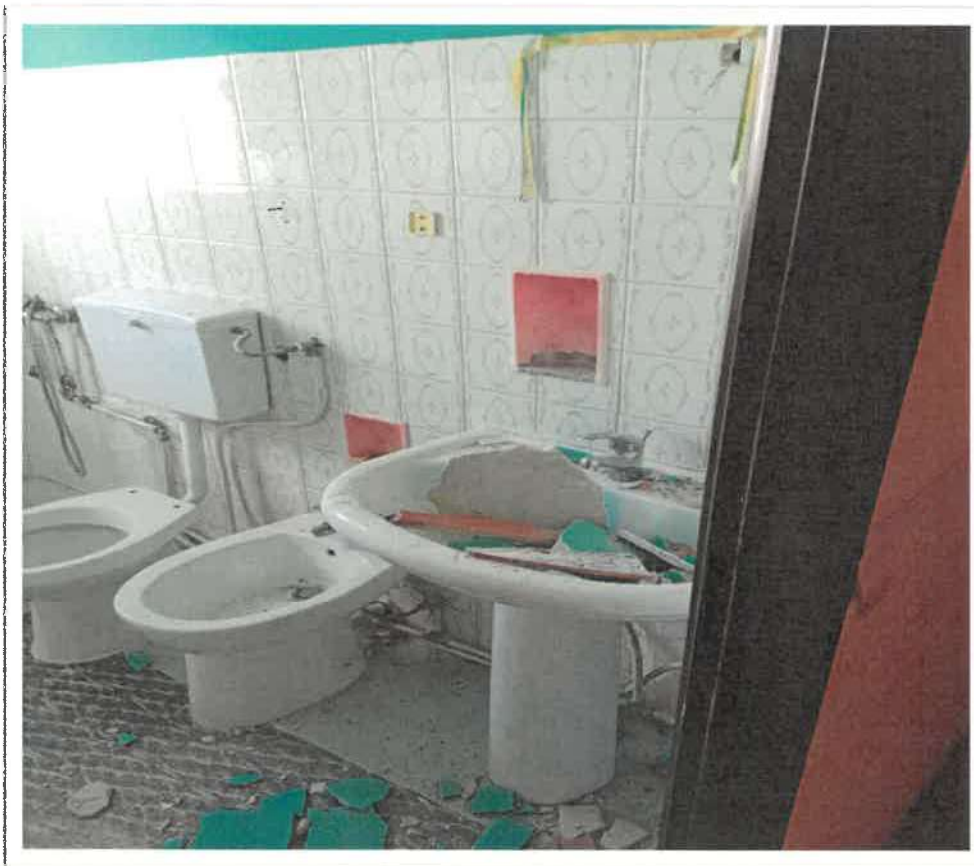
Foto n.ro 33 : i sanitari
