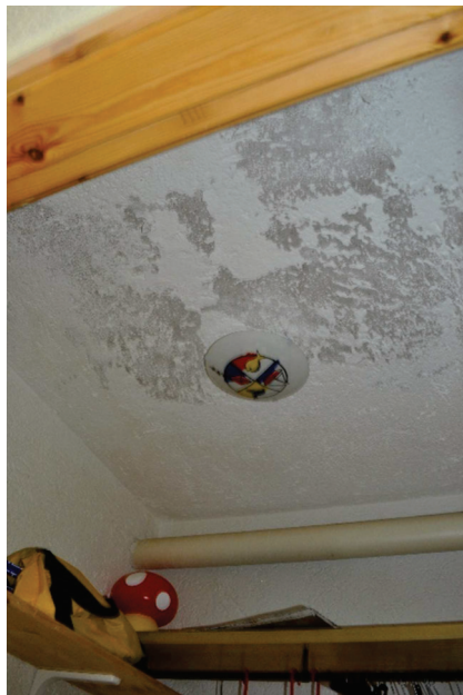
Figg.26-27. Dettaglio dell'umidità sul solaio
