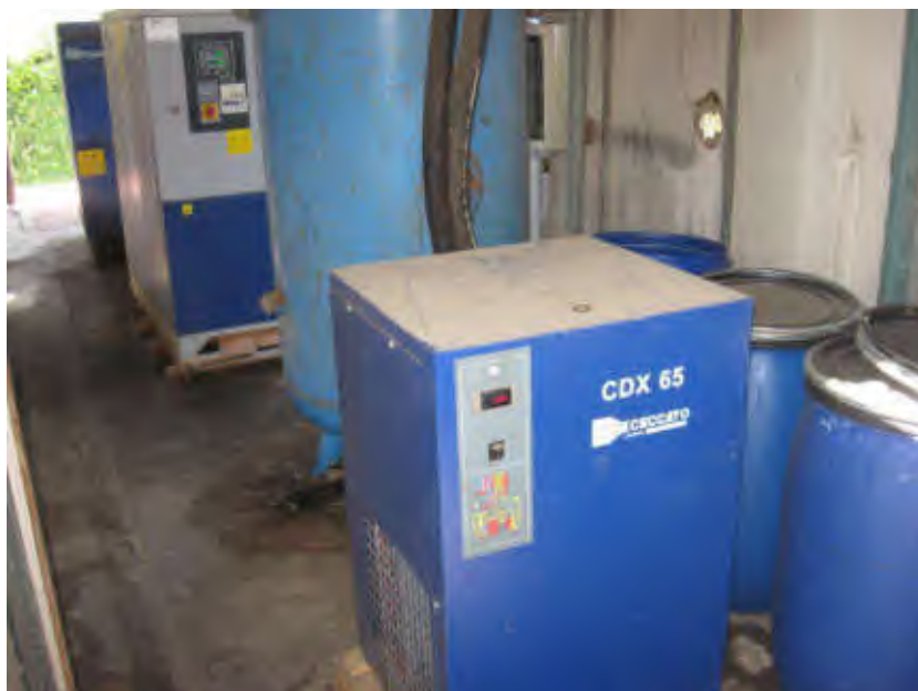
STRUTTURA “ NON AUTORIZZATA ” DA REGOLARIZZARE
