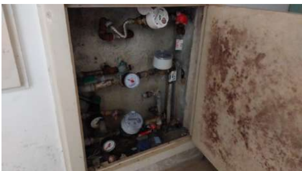
Foto nr.46 : particolare contatori acqua
