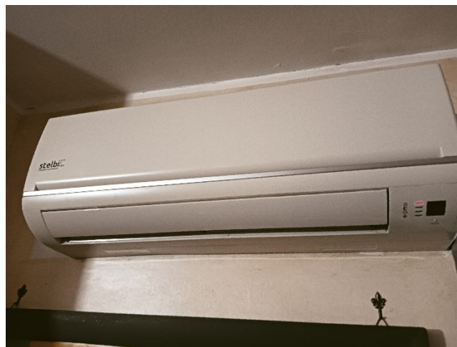
Foto 27: condizionatore aria/aria unità interna
