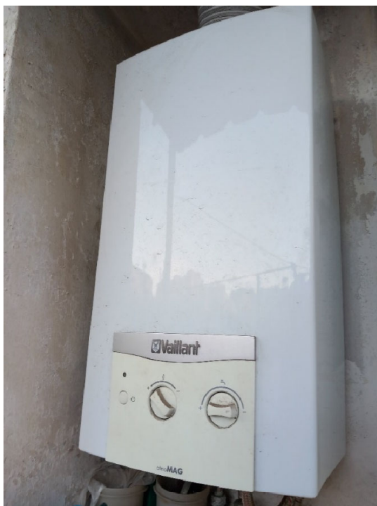
Foto n.17 – balcone n.2 – scaldacqua a gas
