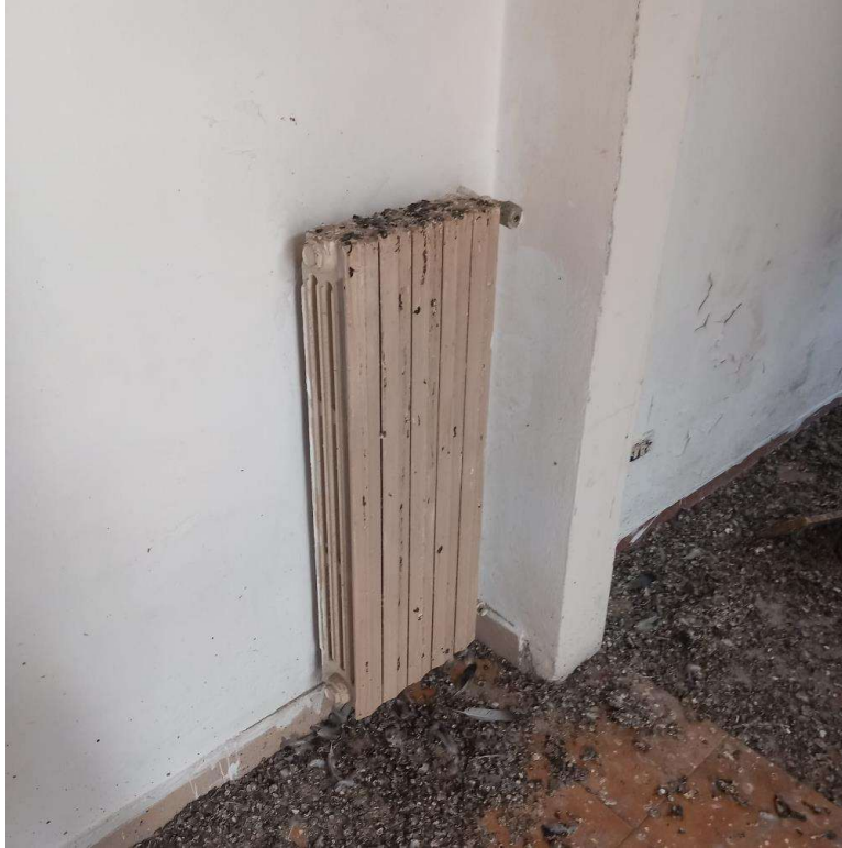
Foto 17 – uno dei termosifoni
