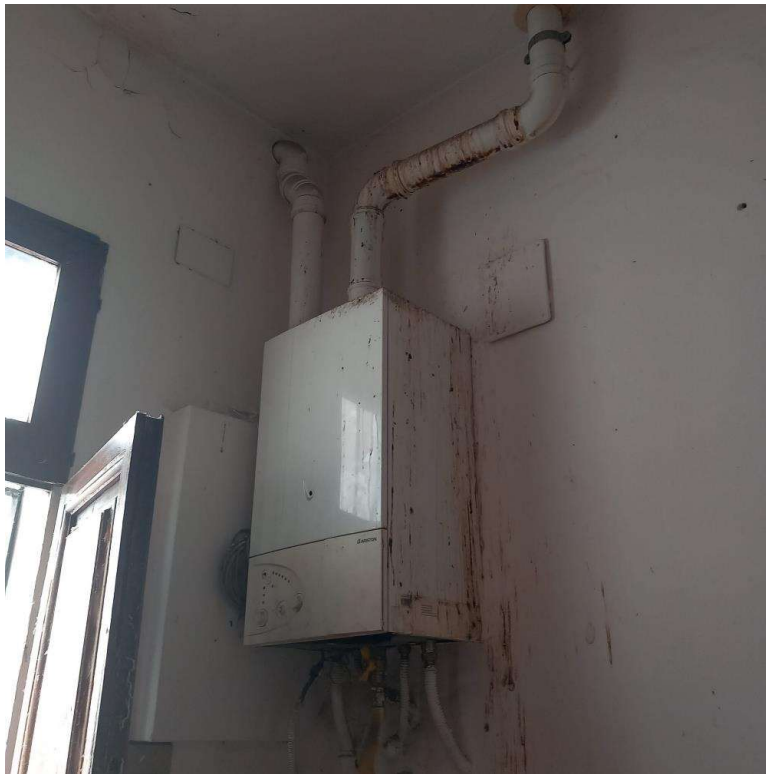
Foto 16 – la caldaia posta all'interno- non funzionante
