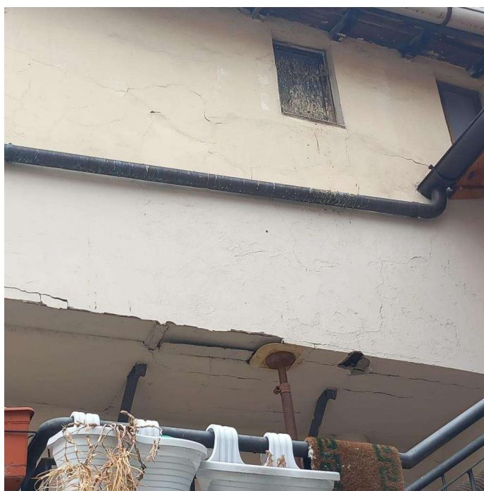
Foto 20: i problemi strutturali del vano wc
