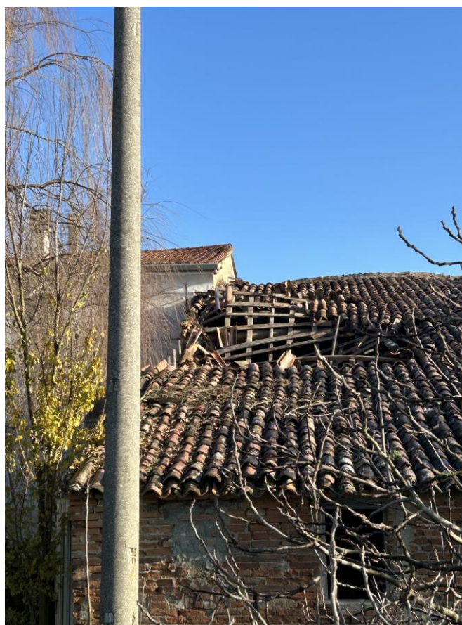
Foto n. 18 – Rustico – Vista frontale danno copertura
