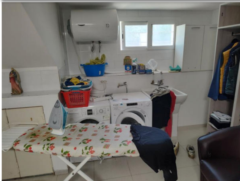
Foto n. 11 – Secondo vano tecnico piano seminterrato
