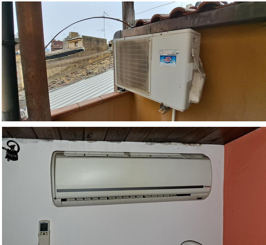
Figura n. 19 e 20 : Impianto Termico condizionatori split con unità esterna.
