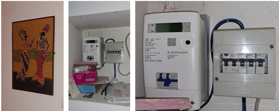
Figura n. 16, 17 e 18 : Rispettivamente contatore ENEL e Quadro Elettrico.
