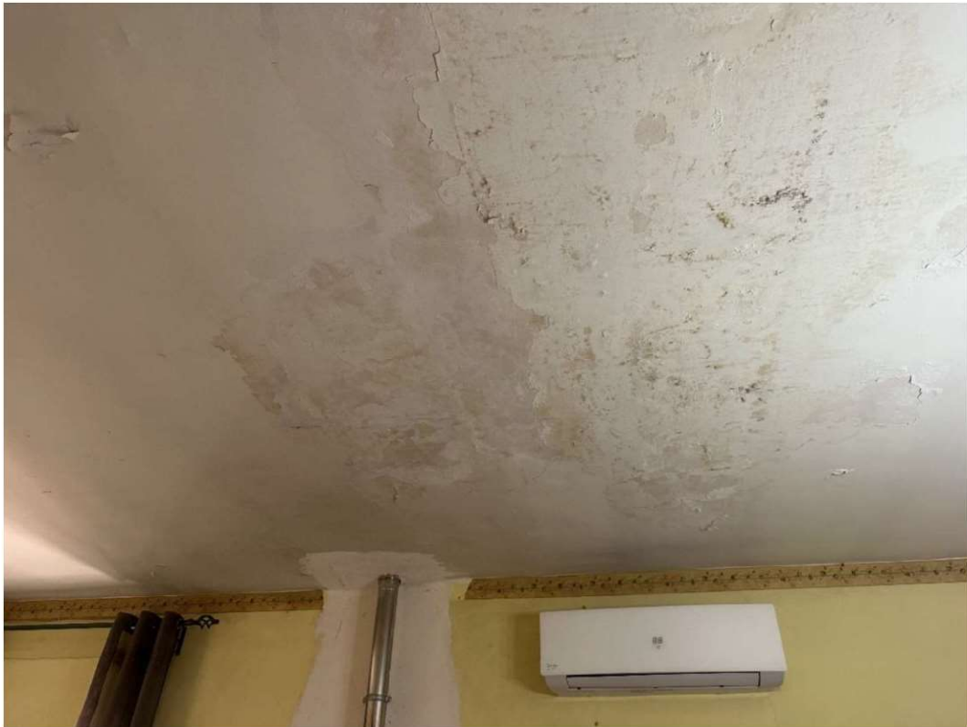
FOTO: PARTICOLARE DELLE MACCHIE DI MUFFA VERDE SUL SOFFITTO DEL VANO SOGGIORN N°1
