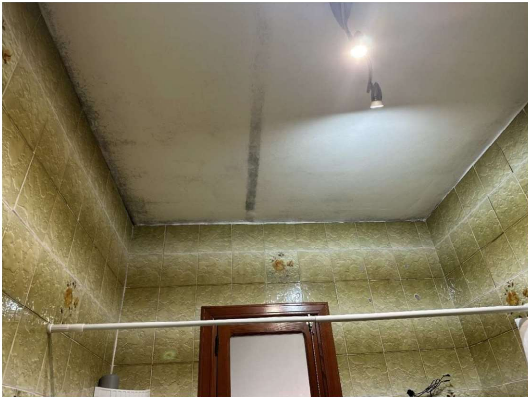
FOTO: PARTICOLARE DELLE MACCHIE DI MUFFA NERA SUL SOFFITTO DEL VANO BAGNO N°2
