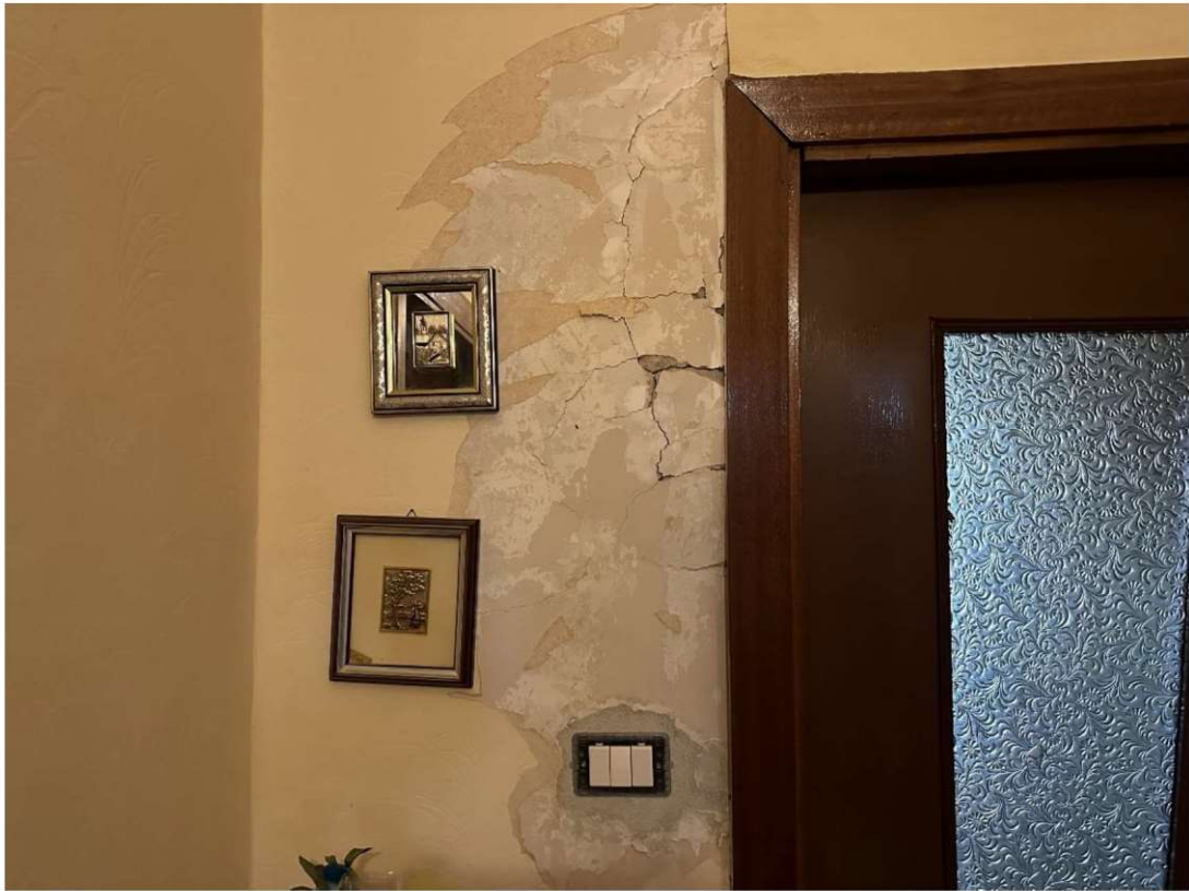
FOTO: PARTICOLARE DELLE DISTACCO DELL'INTONACO SULLA PARETE DEL VANO DISIMPEGNO
