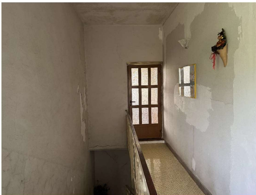
FOTO: PARTICOLARE DELLE DISTACCO DELL'INTONACO SULLE PARETI DEL VANO SCALE
