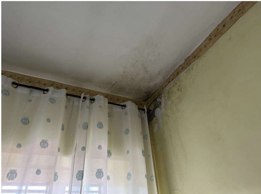
FOTO: PARTICOLARE DELLE MACCHIE DI MUFFA NERA SULLA PARETE DEL VANO SOGGIORNO N°1
