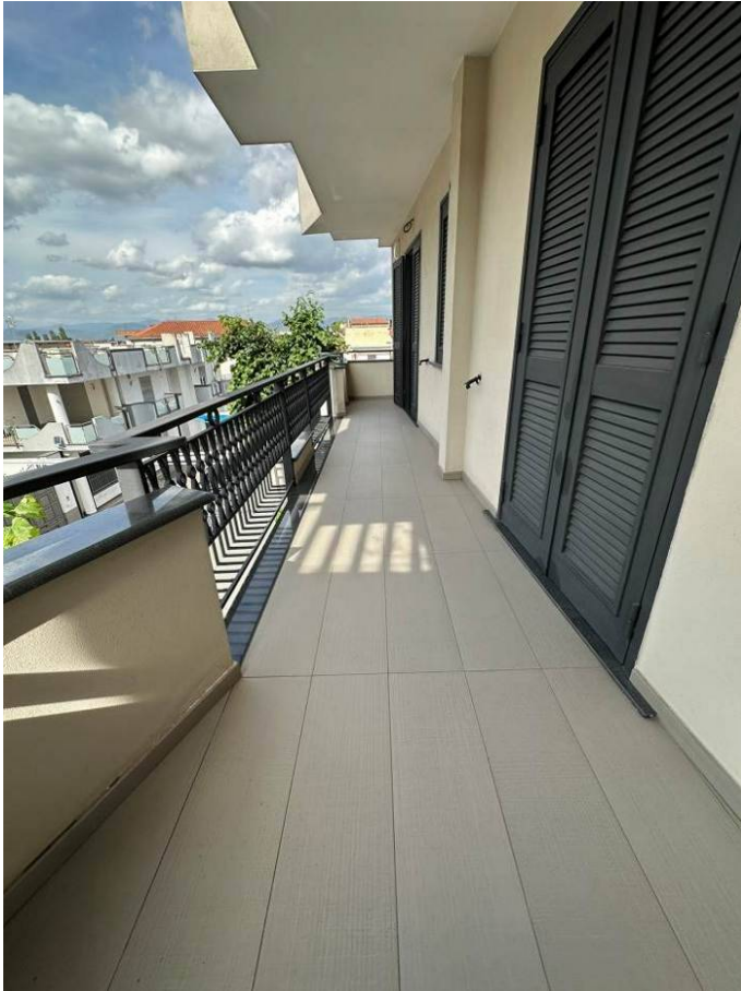
Foto 31 - Il sub 8 – balcone b1
