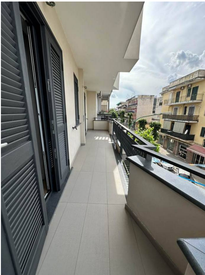
Foto 30 - Il sub 8 – balcone b1
