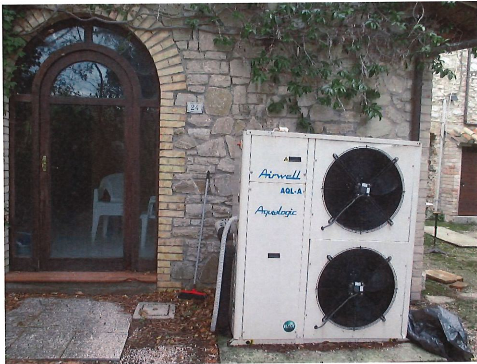
Foto n.28: altro particolare del prospetto est del piano interrato dove è visibile la parte aggettante del portico chiuso al piano terra e da sanare.
