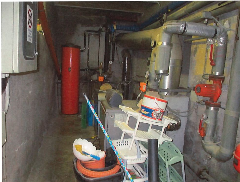
Foto n.76: interno del locale tecnico al piano terra della villa padronale accessibile dalla corte.
