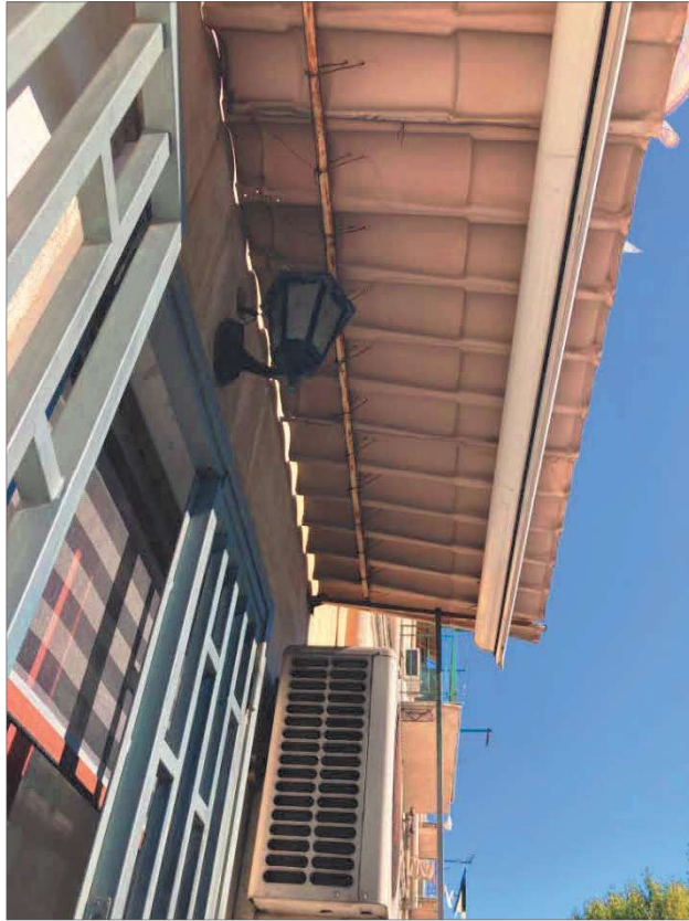
Foto n. 23: Immobile pignorato – particolare tettoia balcone
