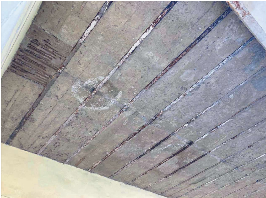
Foto n. 6: Stato di manutenzione del solaio di copertura del ballatoio comune
