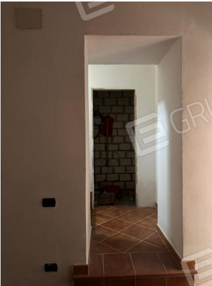
Foto n. 5: Fabbricato adibito a civile abitazione – Ingresso al Bagno 1 e al Vano scala
